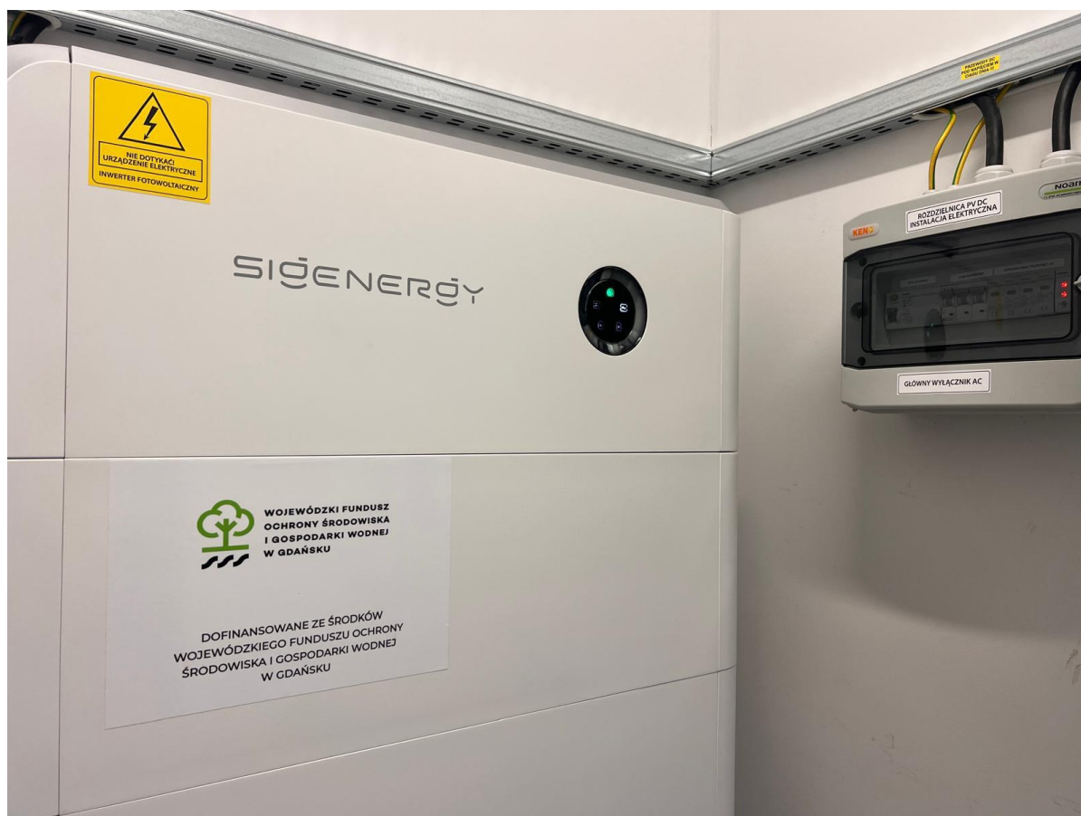
Fot.1 Zdjęcie: Magazyn energii oznakowany tabliczką z informacją o dofinansowaniu z Wojewódzkiego Funduszu Ochrony Środowiska i Gospodarki Wodnej w Gdańsku.
