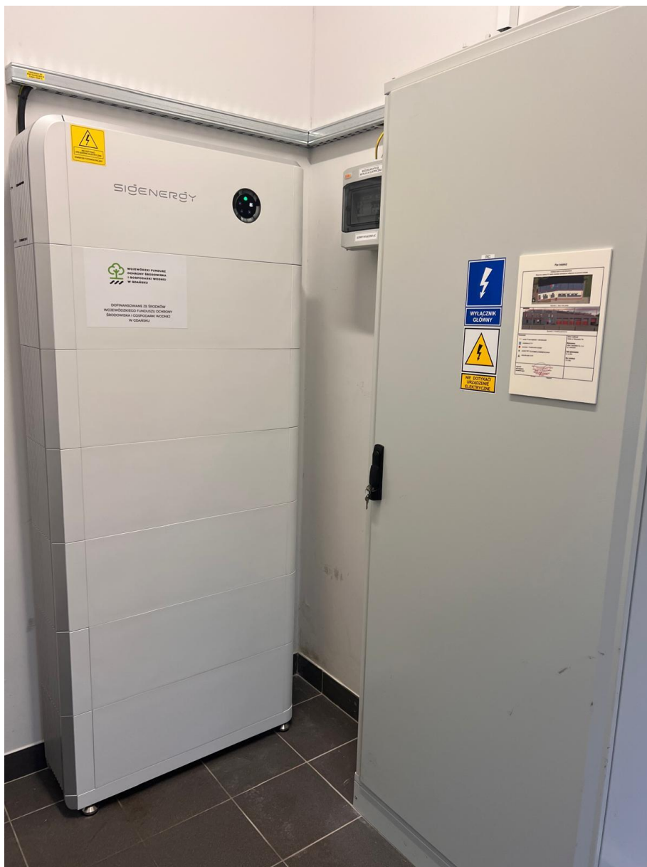
Fot.2 Zdjęcie: Magazyn energii oznakowany tabliczką z informacją o dofinansowaniu z Wojewódzkiego Funduszu Ochrony Środowiska i Gospodarki Wodnej w Gdańsku.
