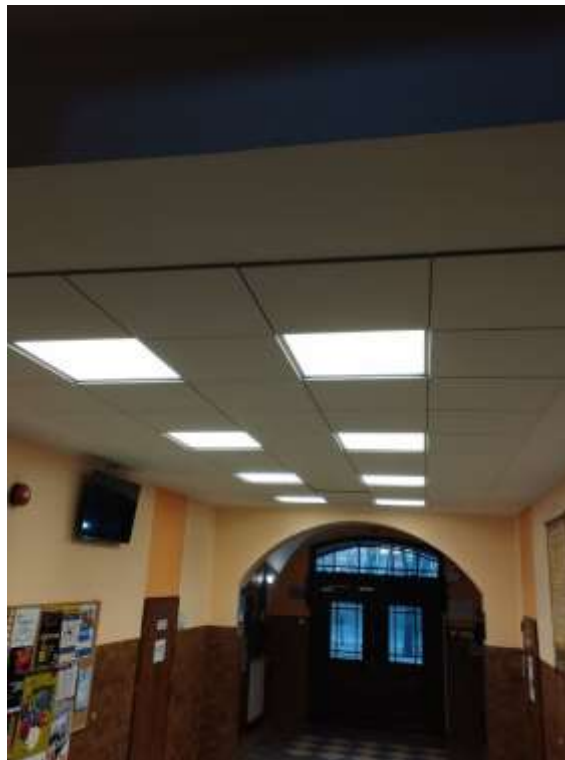
Zdjęcie nr 2. Zmodernizowane oświetlenie w Zespole Szkół Specjalnych im. Marii Konopnickiej w Kościanie – korytarz szkolny
