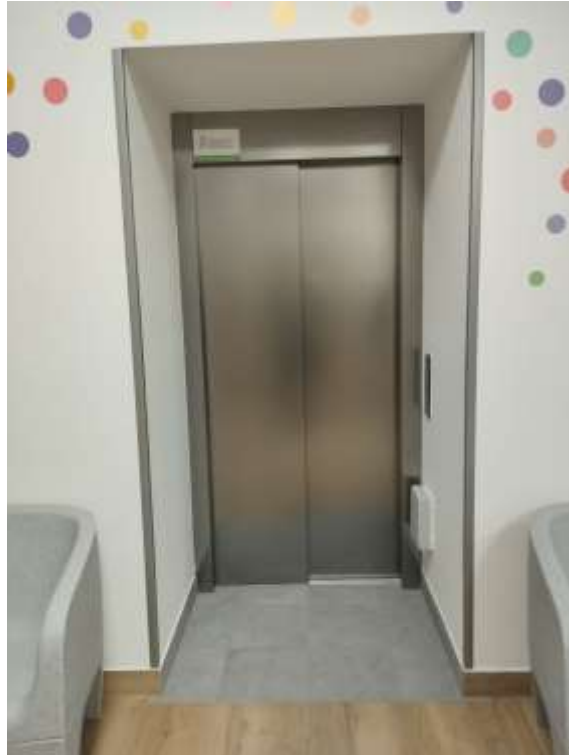
Zdjęcie nr 4. Winda w budynku Zespołu Szkół Specjalnych im. Marii Konopnickiej zlokalizowanym w Kielczewie
