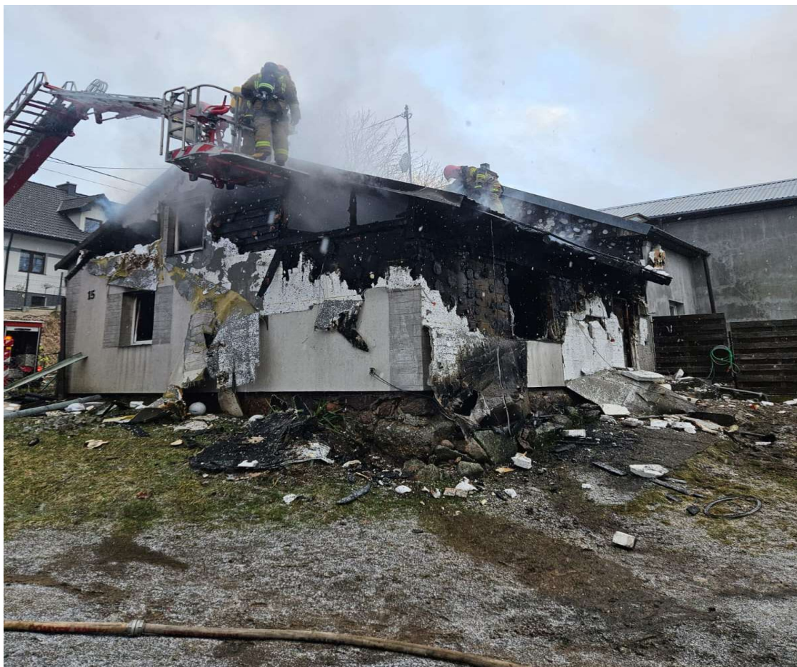
Fot. 3 Pożar budynku wielorodzinnego
