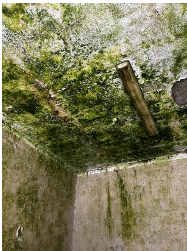
Zdjęcie 10 Zawilgocony zdegradowany strop nad parterem (źródło: zasób Wojewódzkiego Konserwatora Zabytków)
