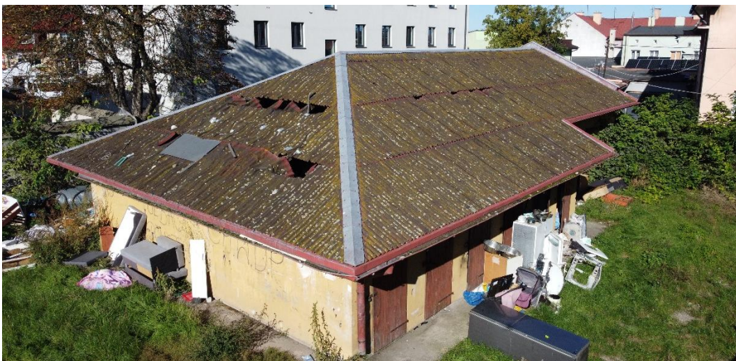
Zdjęcie 14 Widok budynku gospodarczego. Poszycie i orynnowanie zdegradowane
