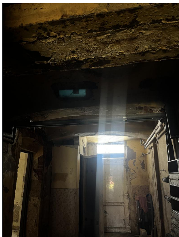
Zdjęcie 12 Widok belki wykonanej z kształtowników. Rozwinięta korozja dwuteowników stalowych, konstrukcja silnie zawilgocona (źródło: zasób Wojewódzkiego Konserwatora Zabytków)
