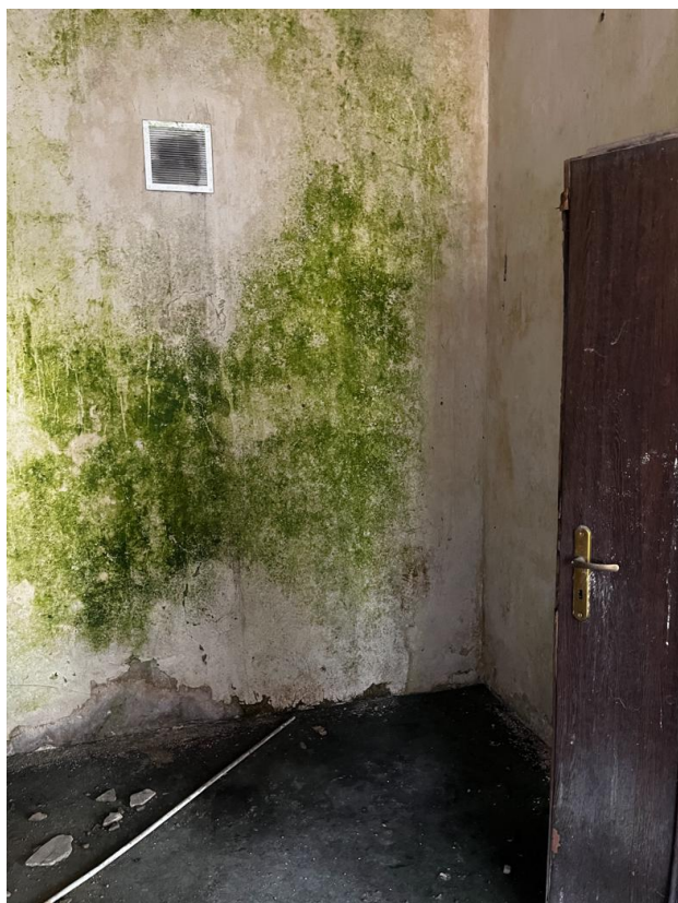
Zdjęcie 11 Zawilgocenie i zagrzybienie ścian w rejonie komina wentylacyjnego (źródło: zasób Wojewódzkiego Konserwatora Zabytków)
