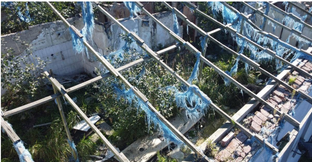
Zdjęcie 6 Szczątkowe tymczasowe zabezpieczenie dachu
