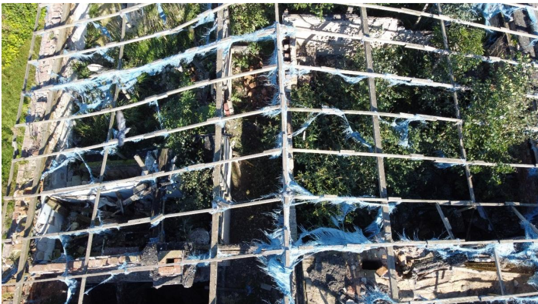
Zdjęcie 7 Konstrukcja dachu wraz z roślinnością wysoką w poziomie stropu nad I piętrem wrośniętą w tankę stropu
