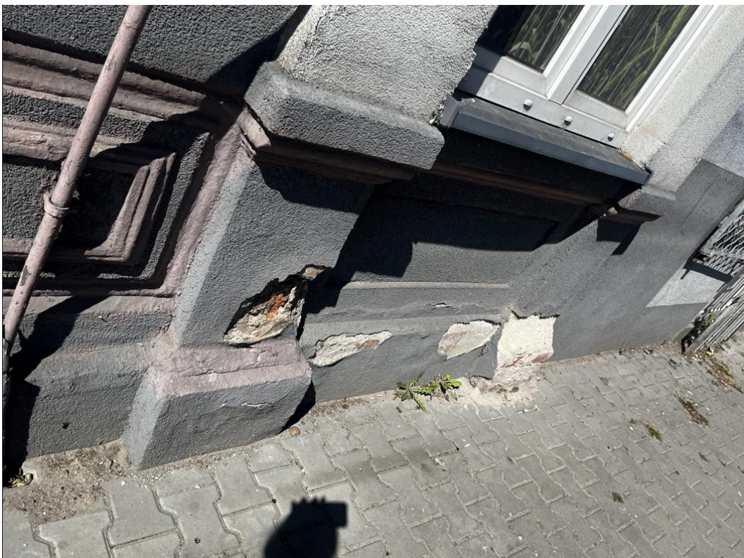
Zdjęcie 8 Uszkodzenia w poziomie cokołu (źródło: zasób Wojewódzkiego Konserwatora Zabytków)
