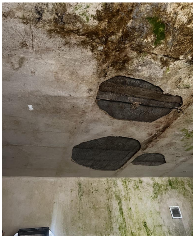
Zdjęcie 9 Odspojony tynk stropu nad parterem, strop zdegradowany (źródło: zasób Wojewódzkiego Konserwatora Zabytków)
