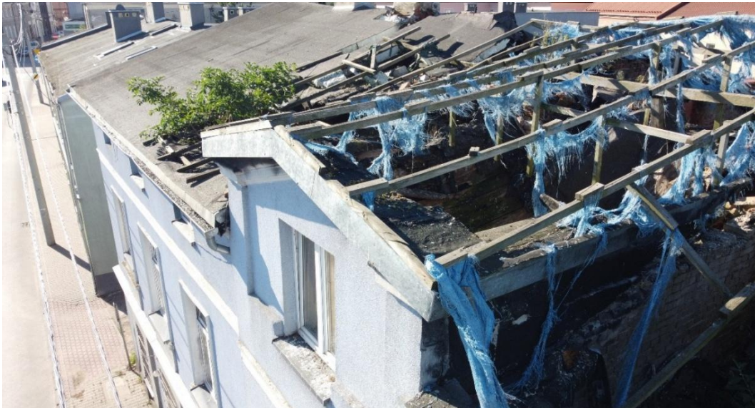
Zdjęcie 4 Widok zniszczonej lukarny
