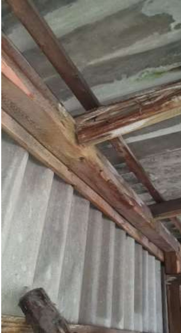
Zgniłe elementy drewniane
