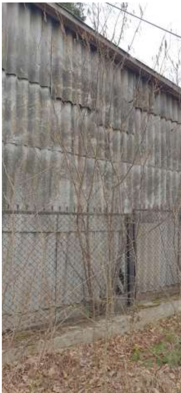
Ściany wypełnione eternitem falistym
