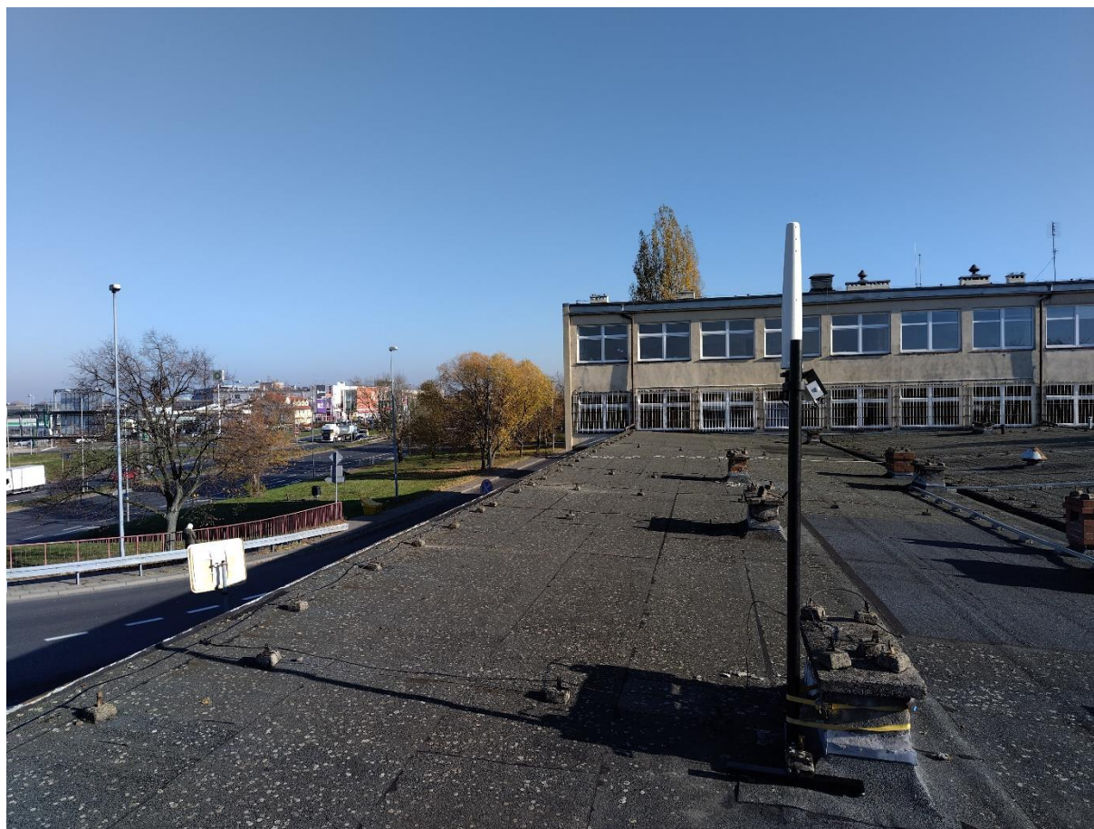
Rys. 3 Miejsce montażu SMS PEM – Szczecińskie Przedsiębiorstwo Autobusowe
