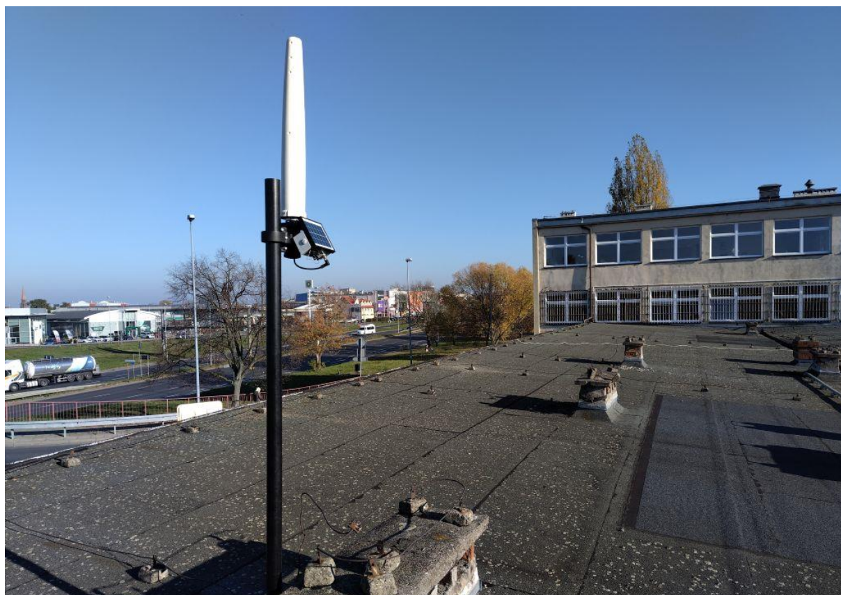
Rys. 2. Miejsce montażu SMS PEM – Szczecińskie Przedsiębiorstwo Autobusowe
