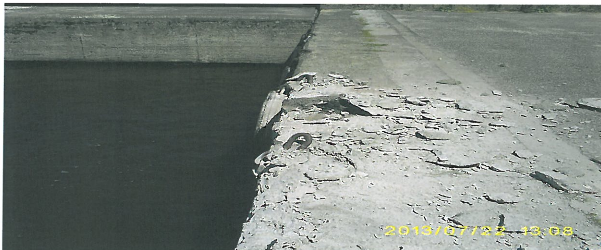
Zdjęcie 8. Uszkodzone nabrzeże
