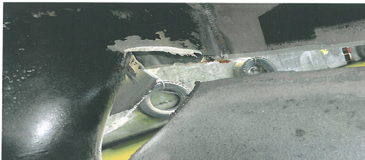
Zdjęcie 6. Pęknięcie kadłuba – widok od wewnątrz statku
