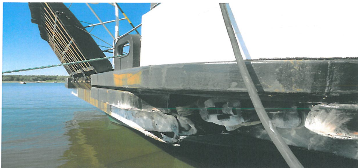
Zdjęcie 4. Uszkodzenie rufy PB
