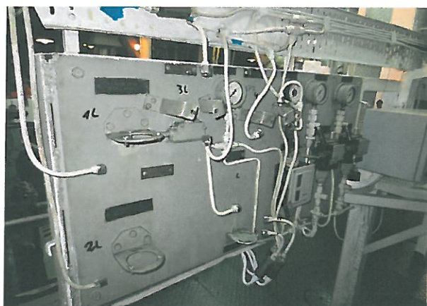
Zdjęcie 16. Tablica kontrolna zdalnego sterowania (bez zdemontowanych elementów)
