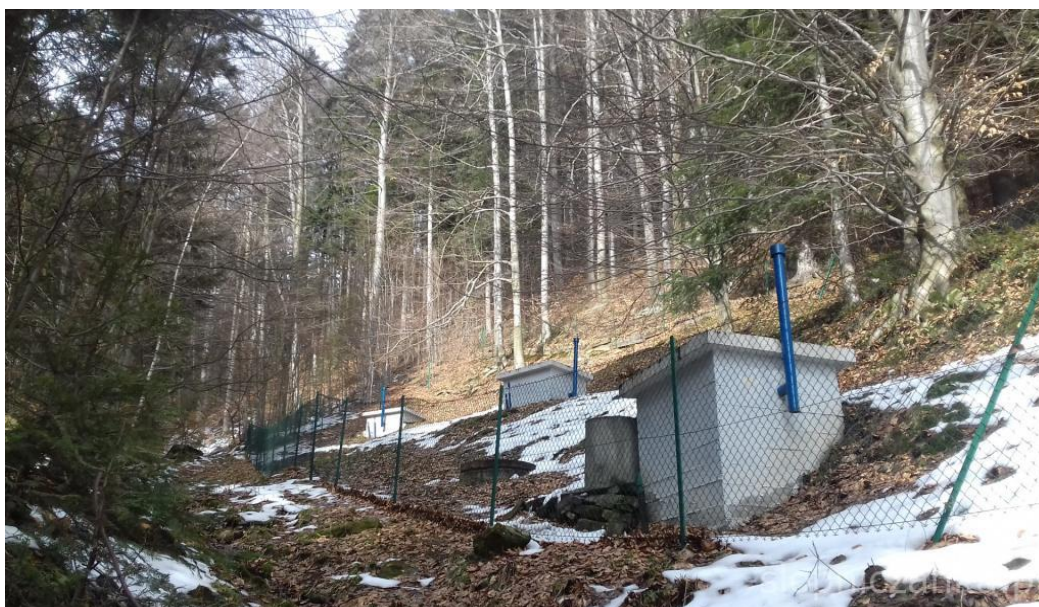
Obraz 8 Zbiorniki - wodociąg wiejski Słopnice
