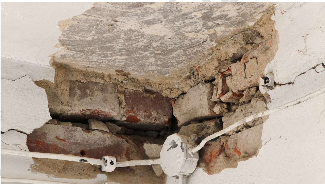
Fot. Uszkodzenia ścian - zarysowania
