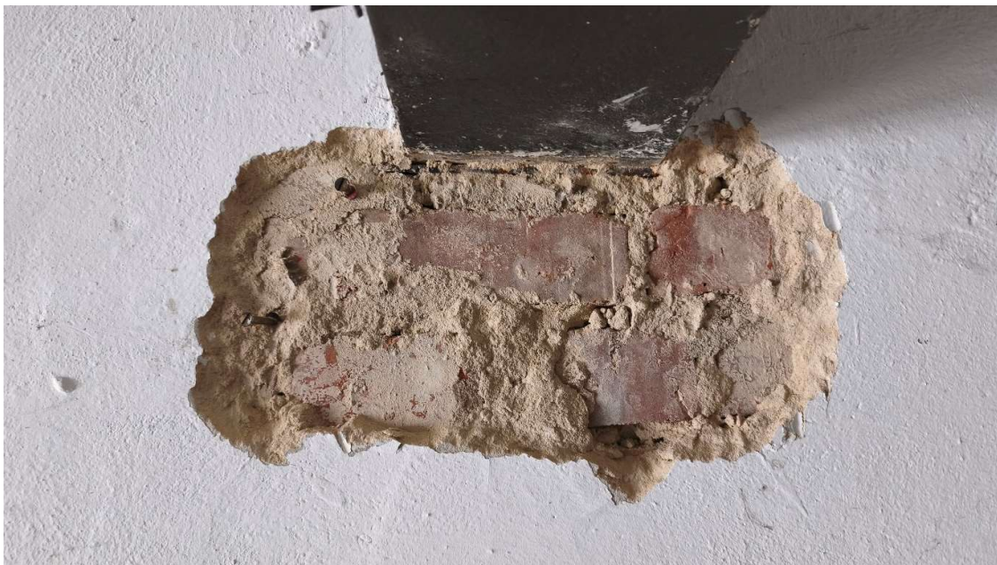
Fot. Uszkodzenia oparcia belki stalowej
