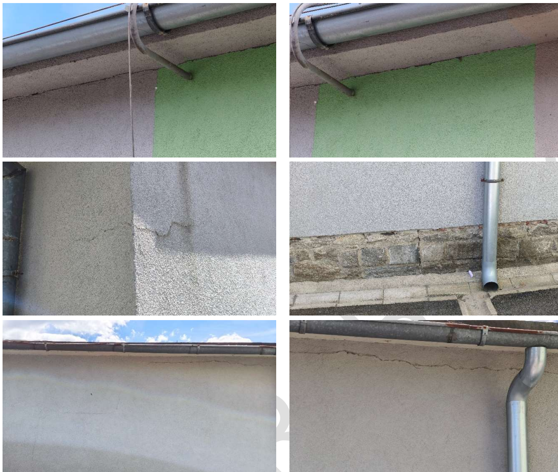
Fot. Zarysowania powstałe w ścianach podłużnych - szczegóły
