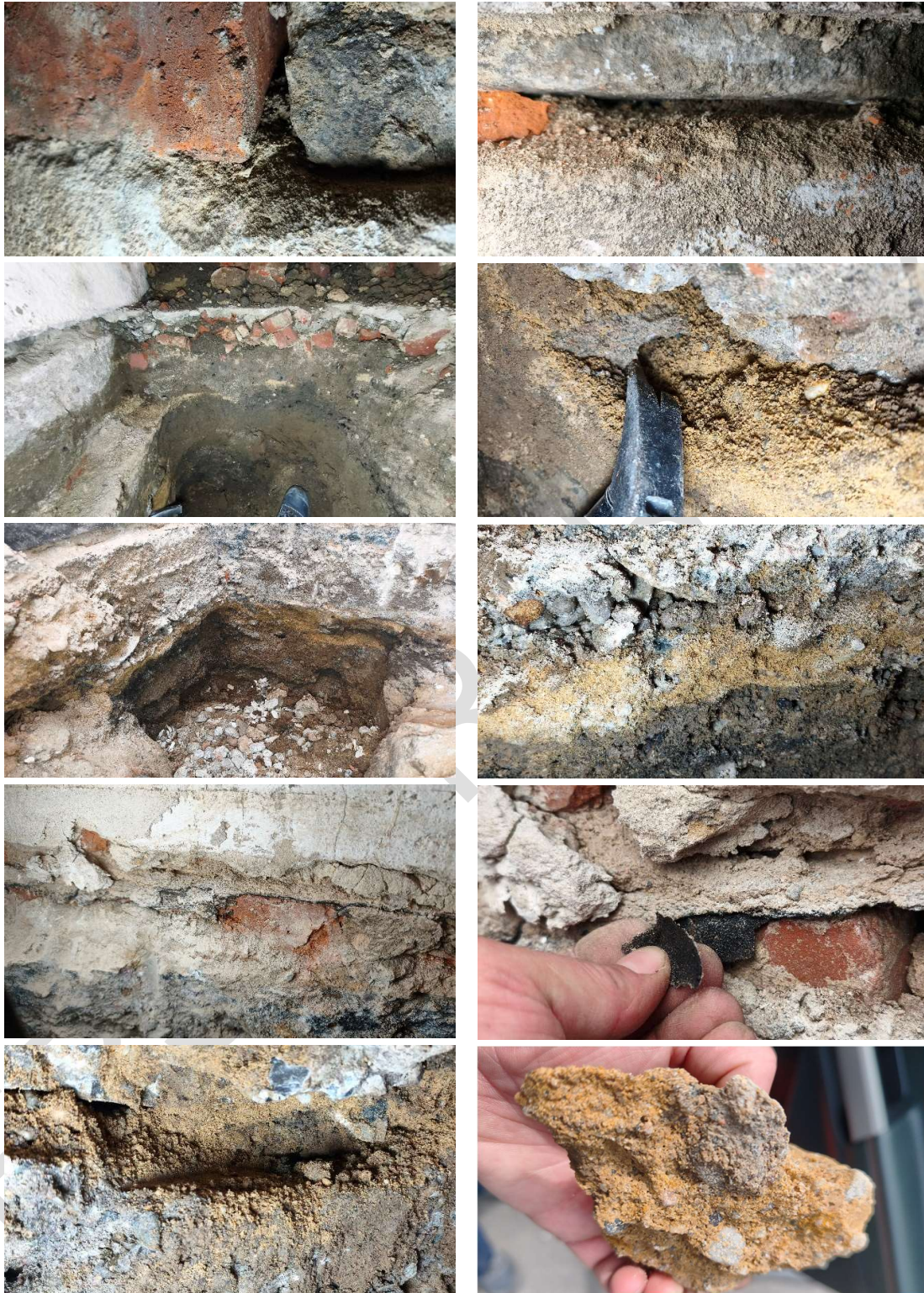
Fot. Materiał budulcowy oraz uszkodzenia w ławach fundamentowych
