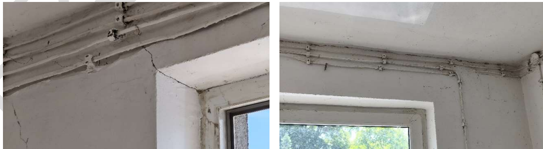
Fot. Zarysowania muru w miejscach naroży otworów
