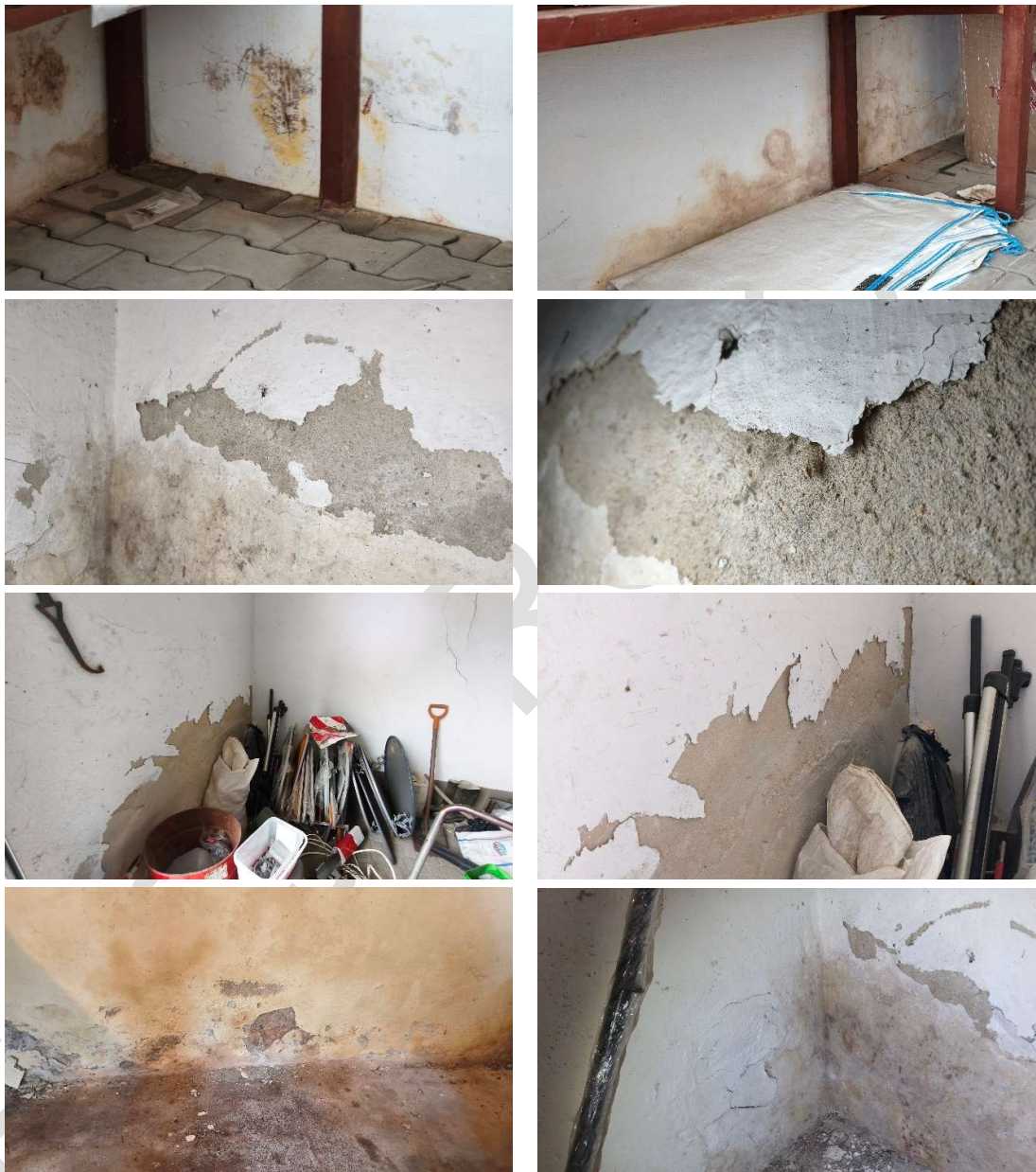
Fot. Ściany z widocznym zawilgoceniem i zagrzybieniem
