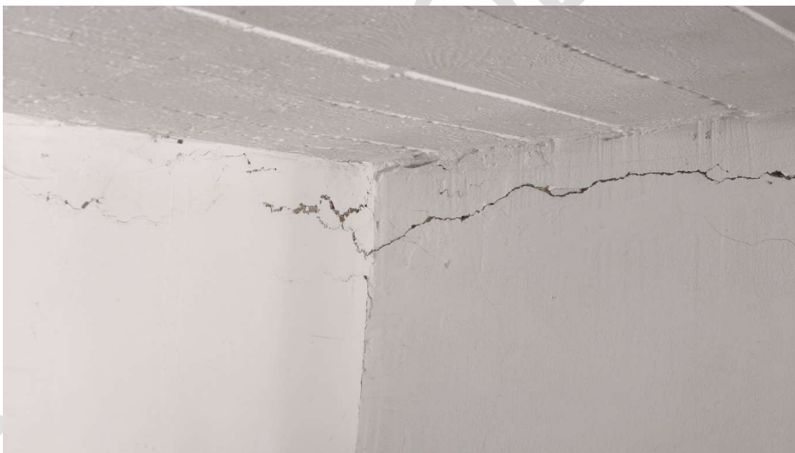
Fot. Uszkodzenia ścian - zarysowania
