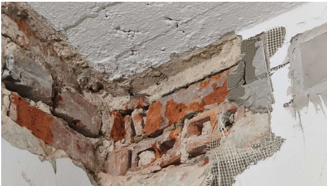
Fot. Uszkodzenia ścian - zarysowania
