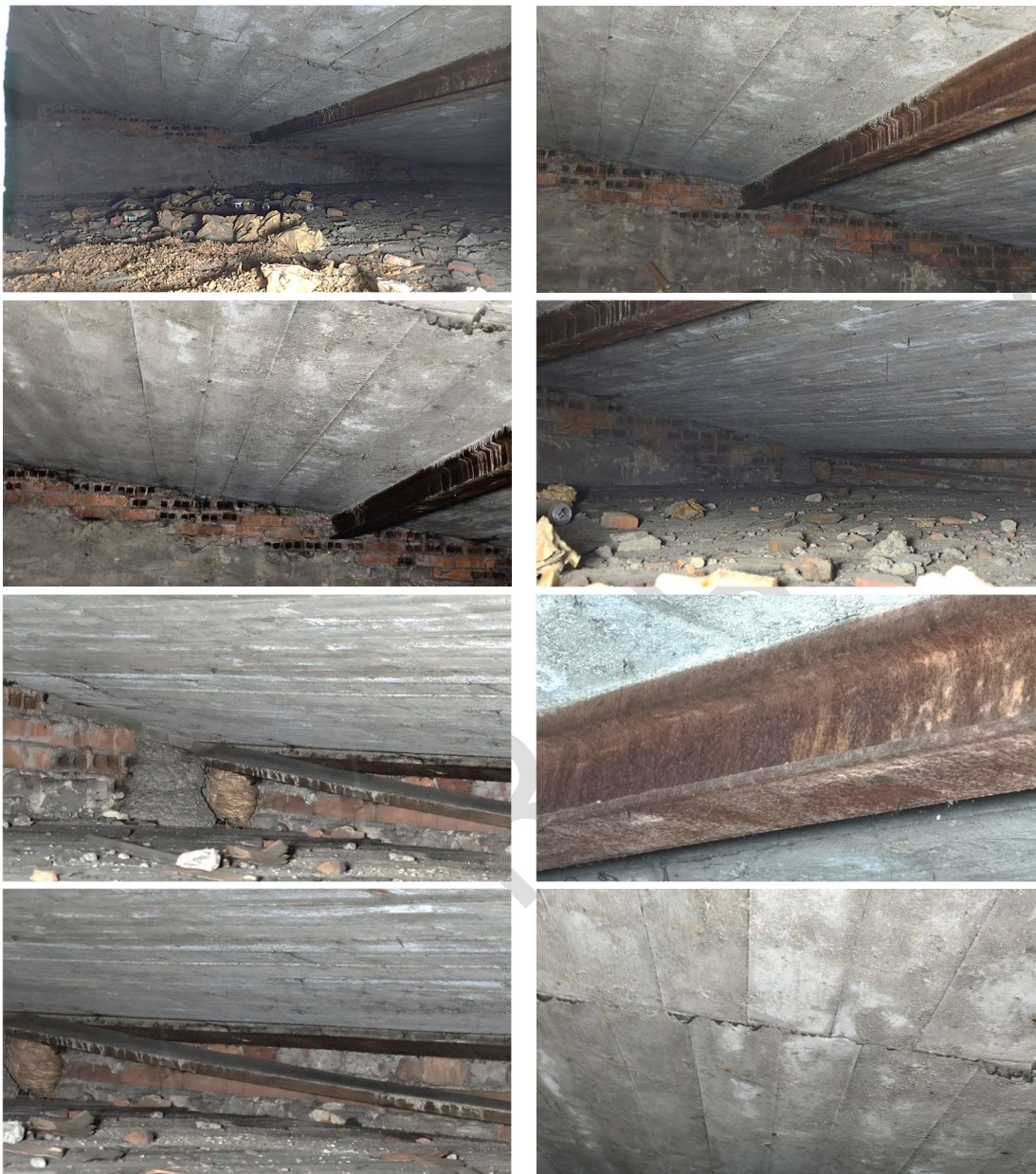
Fot. Strefa pomiędzy płytą stropową a dachem w pomieszczeniu skrajnym (od wschodu). Widoczny materiał z jakiego zbudowana jest ściana szczytowa – m. in. cegła dziurawka. Słaba jakość wykonania. Korozja elementów stalowych
