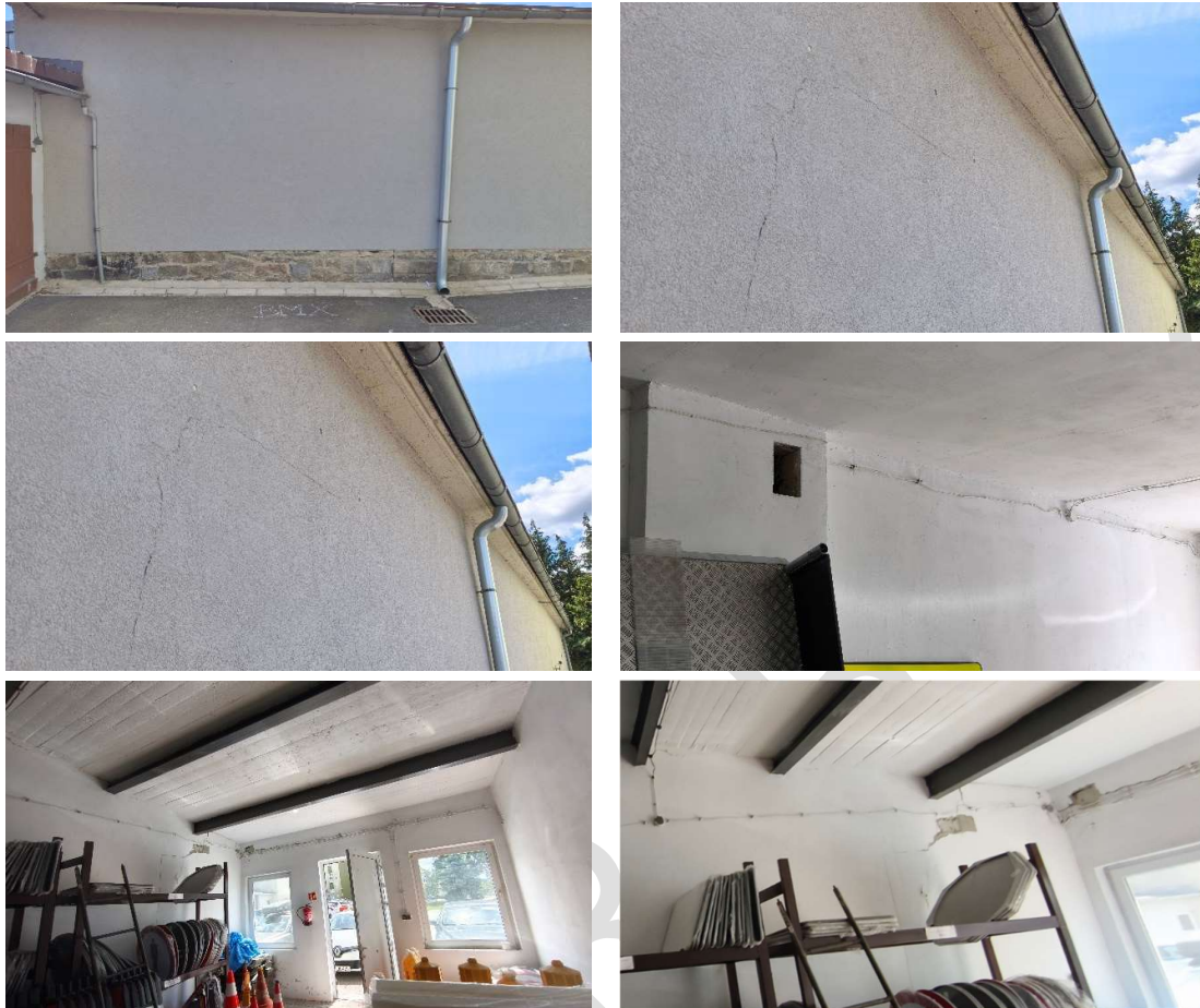
Fot. Zarysowania muru w miejscach zamurowani otworów
