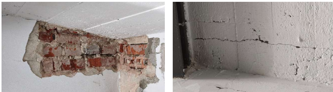
Rys. Zarysowania powstałe w strefie oparcia konstrukcji żelbetowej (z belkami stalowymi) dachu na murze
