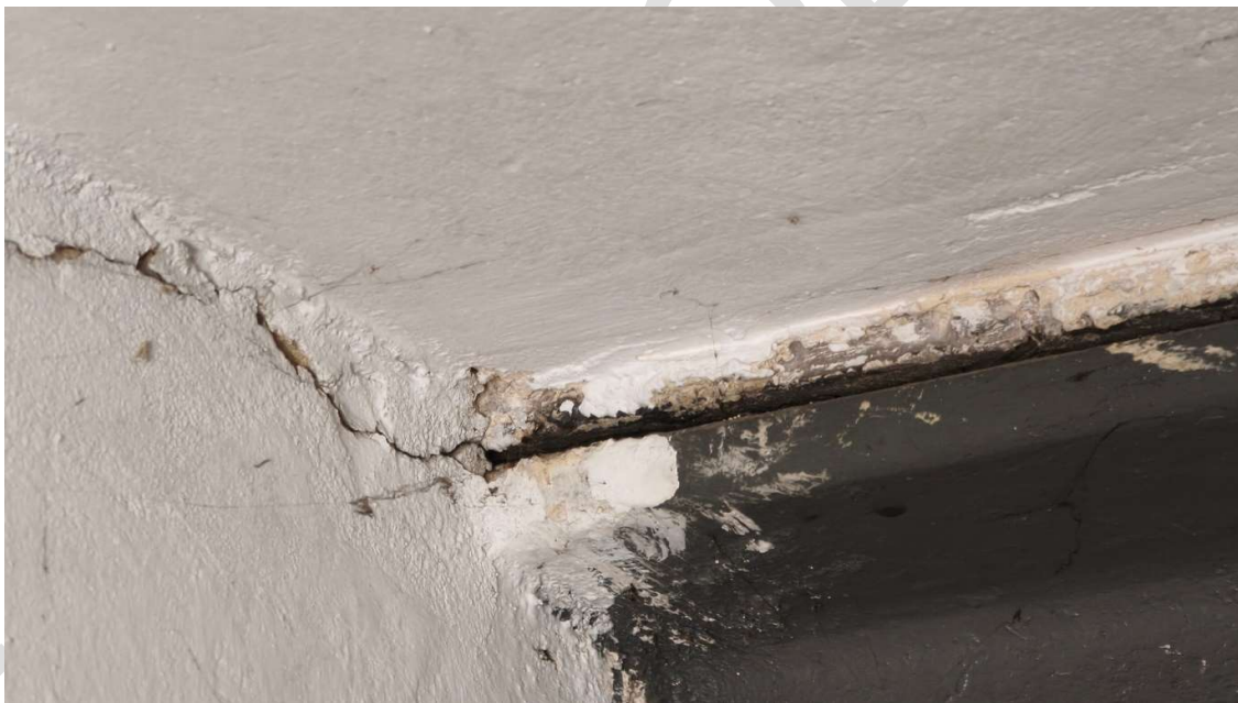
Fot. Odspojenie górnej półki dwuteownika od płyty żelbetowej dachu
