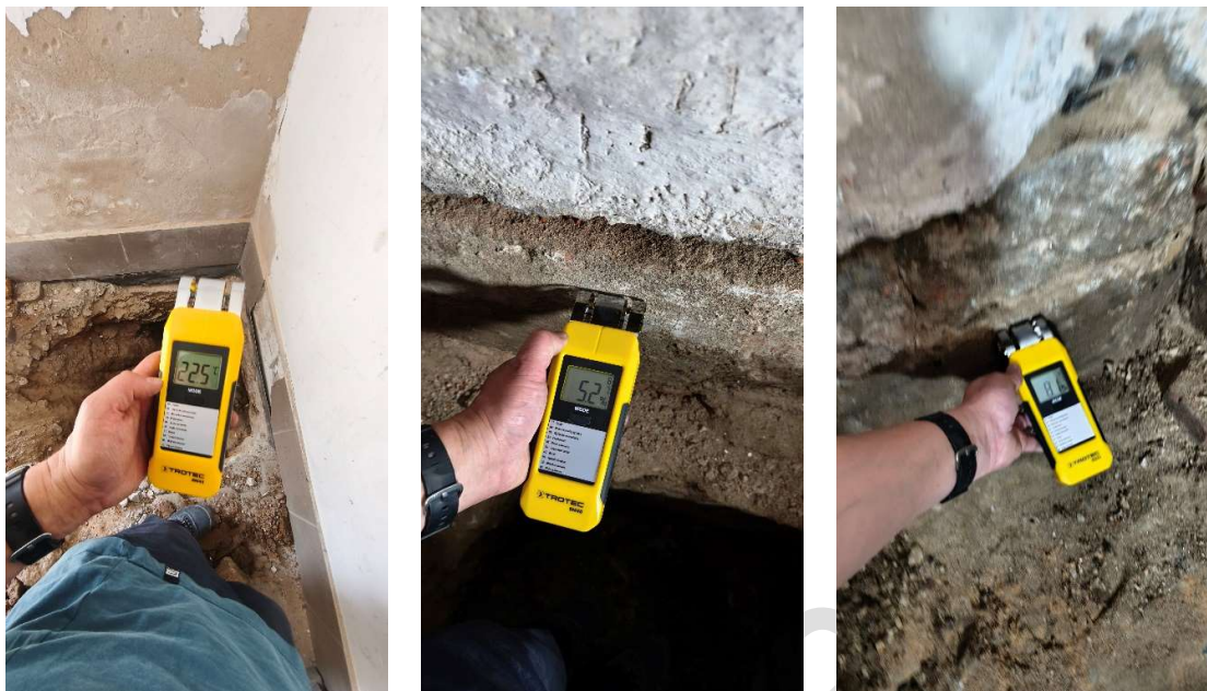
Fot. Pomiar wilgotności ławy fundamentowej poniżej poziomu posadowienia – wynik: ściana jest średnio zawilgocona (wilgotność 4-8%)
