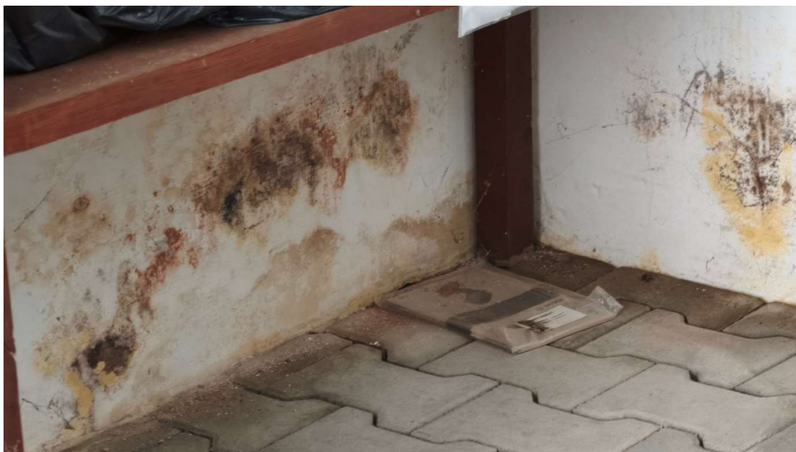
Fot. Zawilgocenia ścian
