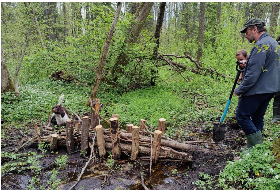
Rysunek VI.11 Drewniana budowla piętrząca zlokalizowana w lokalnym obniżeniu prowadzącym wody roztopowe i opadowe, niebędącym ciekim w ewidencji Wód Polskich, zbudowana przez Administrację Lasów Państwowych na obszarze Puszczy Białowieskiej. Fotografia: Mateusz Grygoruk.
