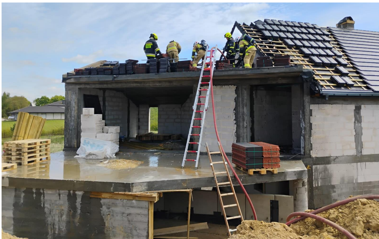
Zdjęcie – pożar budynku jednorodzinnego w budowie
