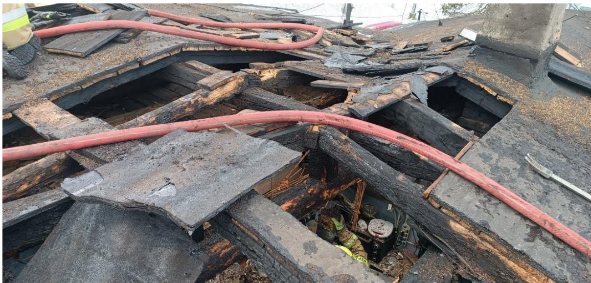
Zdjęcie – pożar poddasza i dachu w budynku wielorodzinnym
