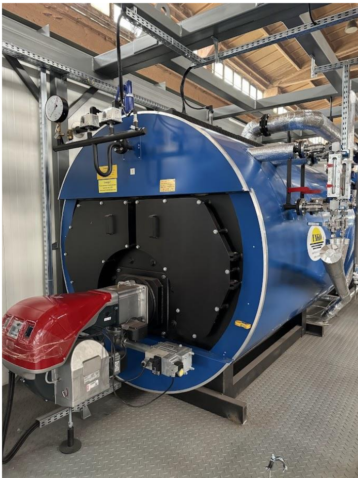
Rys. 26. Zdjęcie poglądowe kotła parowego RPW z osprzętem [46].
