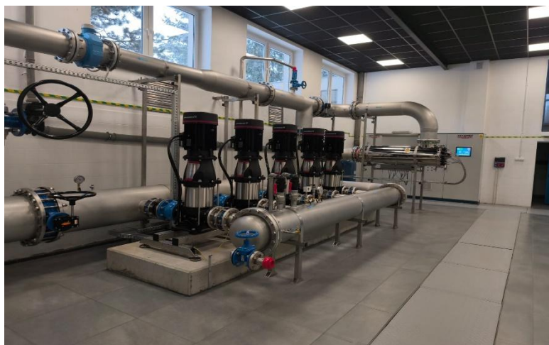
Pompownia – pompy sieciowe - Stacja Uzdatniania Wody Strzyżewice.
