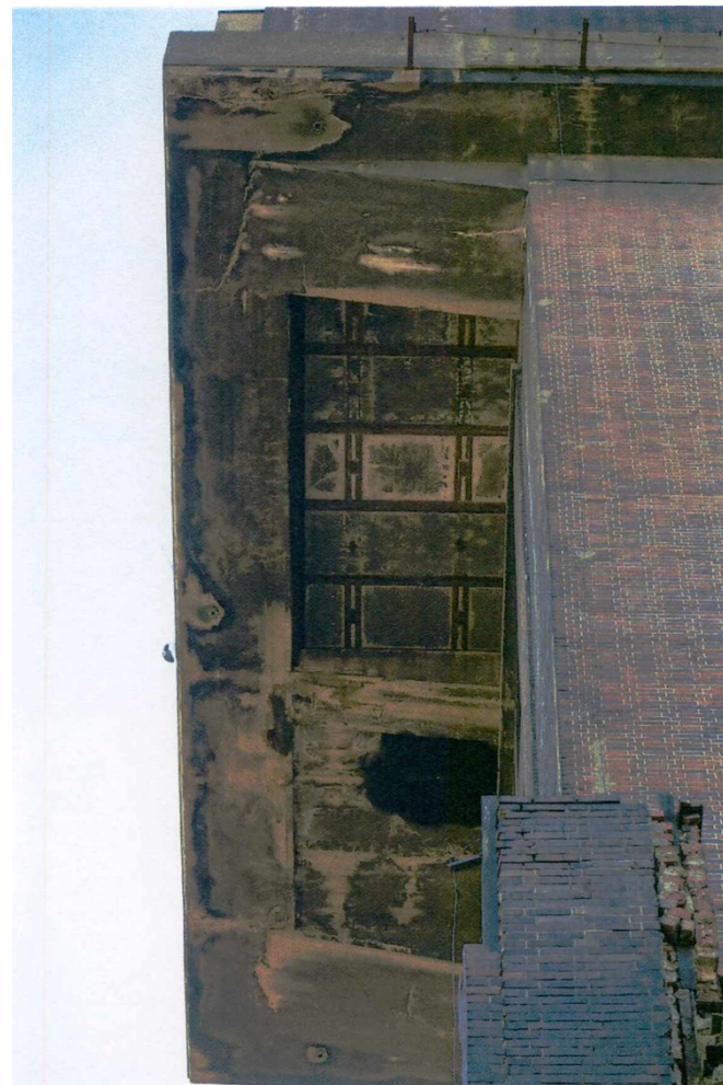
9. Widoczna degradacja żelbetowego stropu na poziomie +40,65 m.
