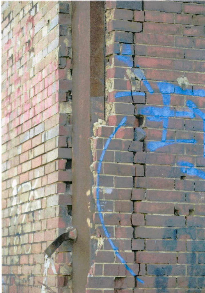
10. Elewacja wschodnia - rozwarstwienia struktury lica elewacji, zdegradowana i skorodowana ślusarka okienna.
