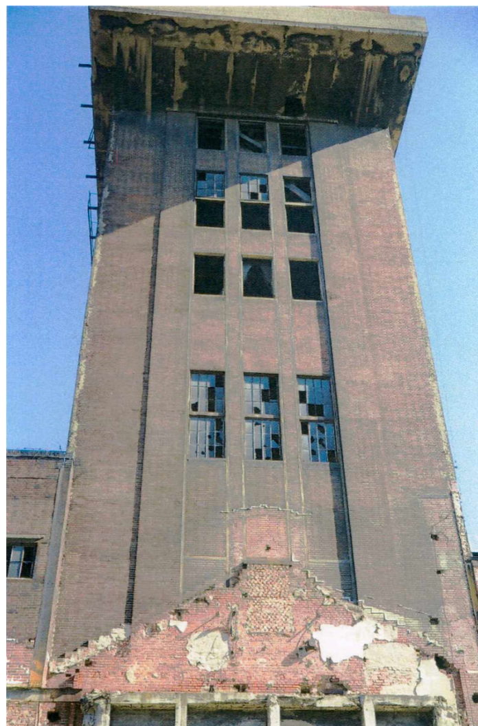
4. Stan zachowania elewacji zachodniej poniżej poziomu +40,65 m.
