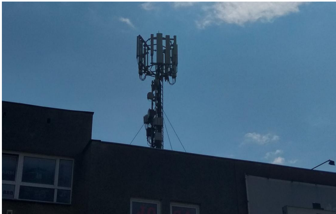
Fot. 1: Widok anten stacji bazowej: ID OPO1030, zlokalizowanej przy ul. Wrocławskiej 107 w Opolu
