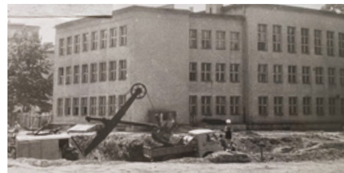
Fot. 5. Zdjęcie z kroniki szkolnej: budynek przy ul. Szczucińskiej w trakcie rozpoczynających się prac budowlanych
