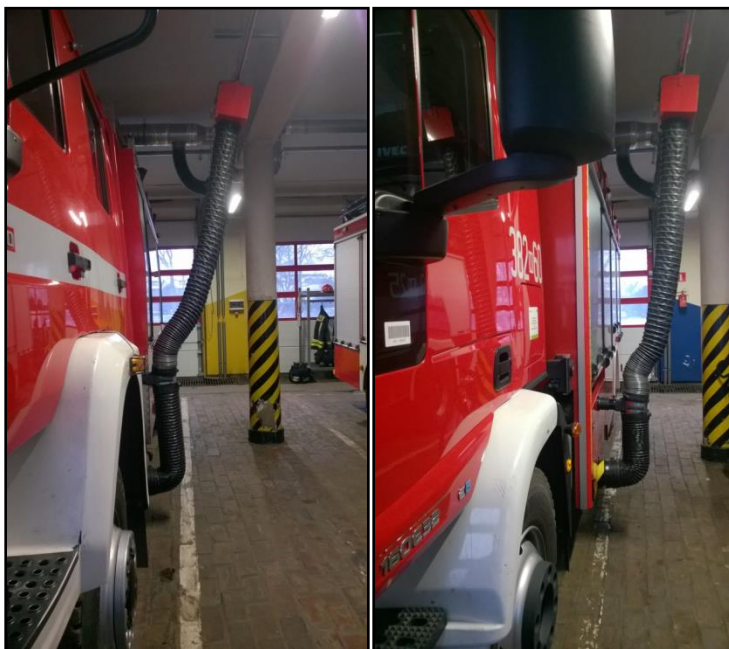
Fot. Odciągi spalin w JRG nr 2.
