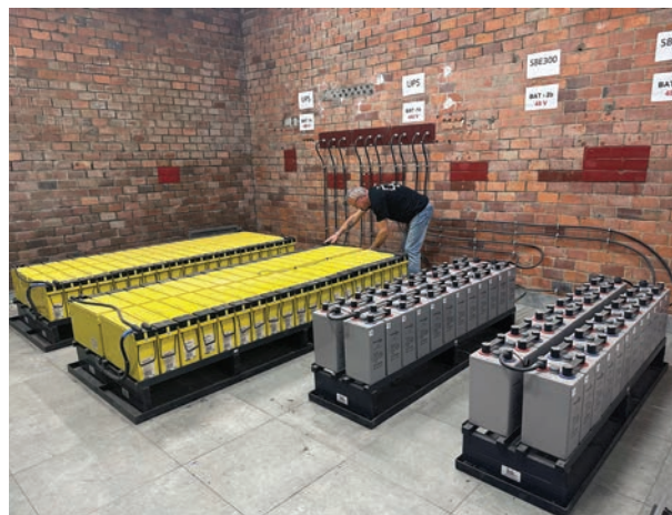
► Rys. 4. Baterie akumulatorów
