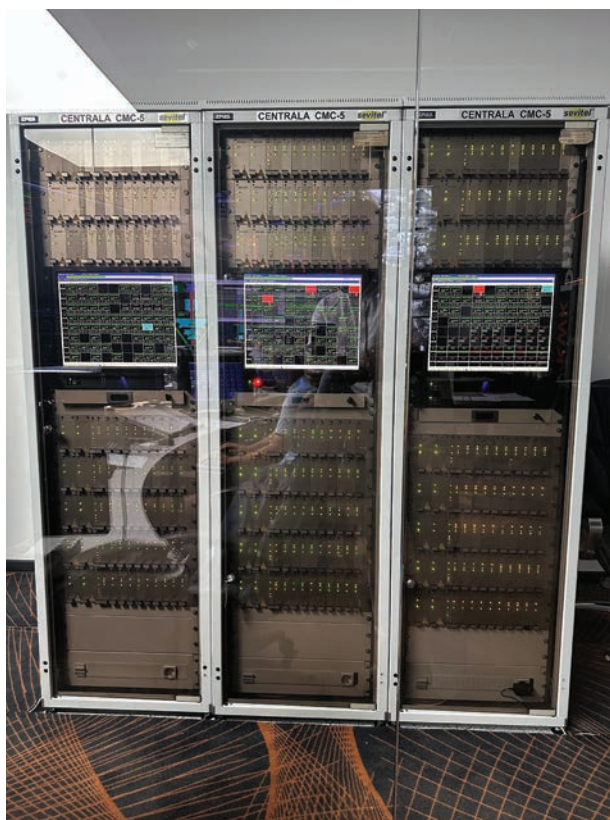
► Rys. 13. Centrale CMC-5
