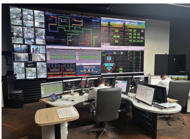
► Rys. 11. Stanowisko pracy dyspozytorów ruchu
