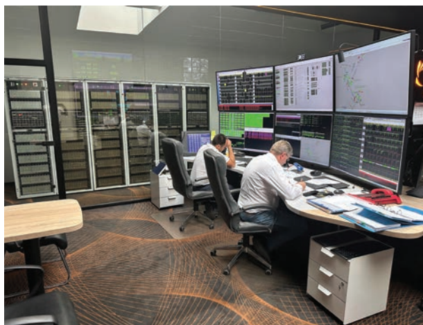
► Rys. 14. Stanowisko dyspozytora gazometrii wraz z centralami CST-40C
