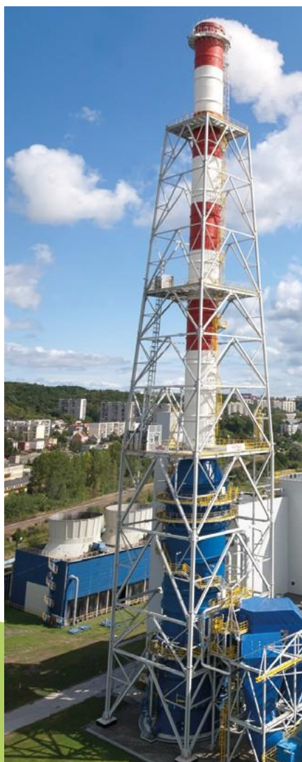
Instalacja odsiarczania spalin (IMOS) w EC Gdyńskiej
