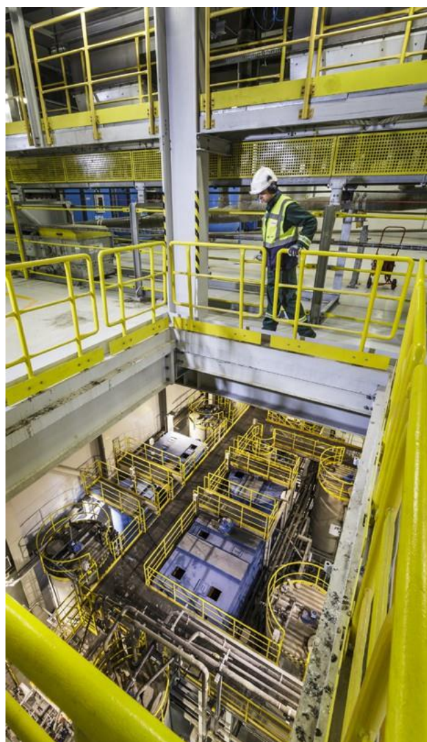
Instalacja odsiarczania spalin (IMOS) w EC Gdańskiej
