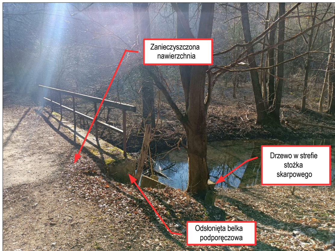
Fot. 2 - Widok na odsłoniętą belkę podporęczową, zanieczyszczoną płytę pomostu, drzewo w strefie stożka skarpowego
