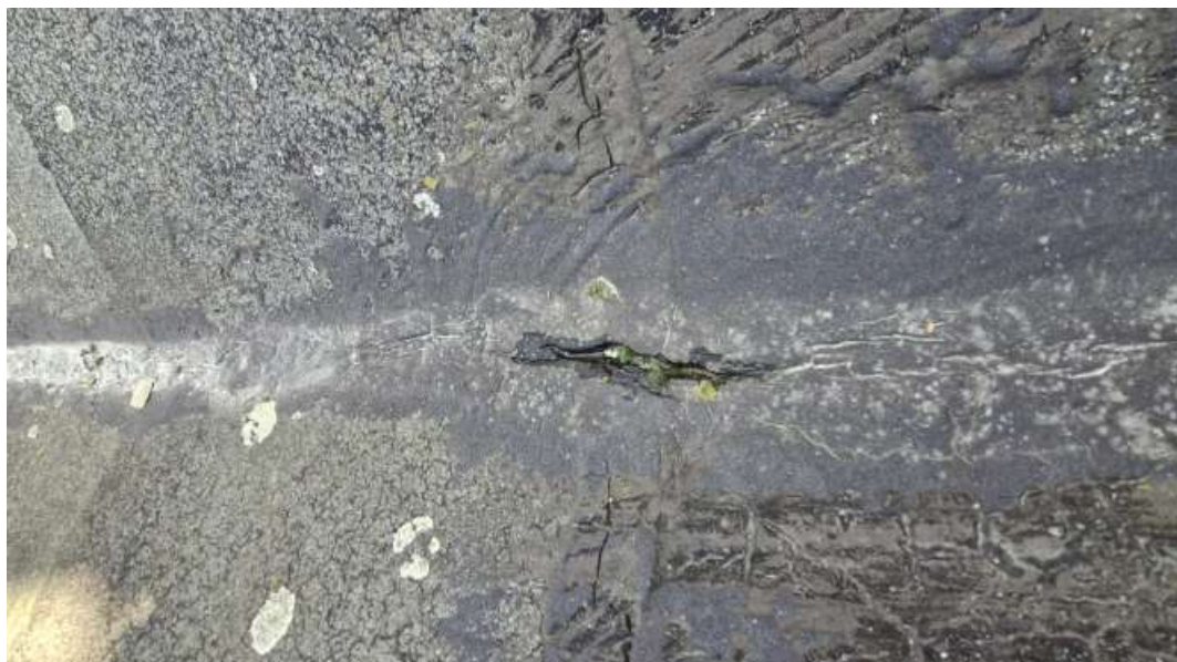
Zdjęcie 1 Miejsce mocnego spękania papy na dachu wieżyczki (w obszarze koryta znajdują się co najmniej kilka pęknięć które należy zakleić)
