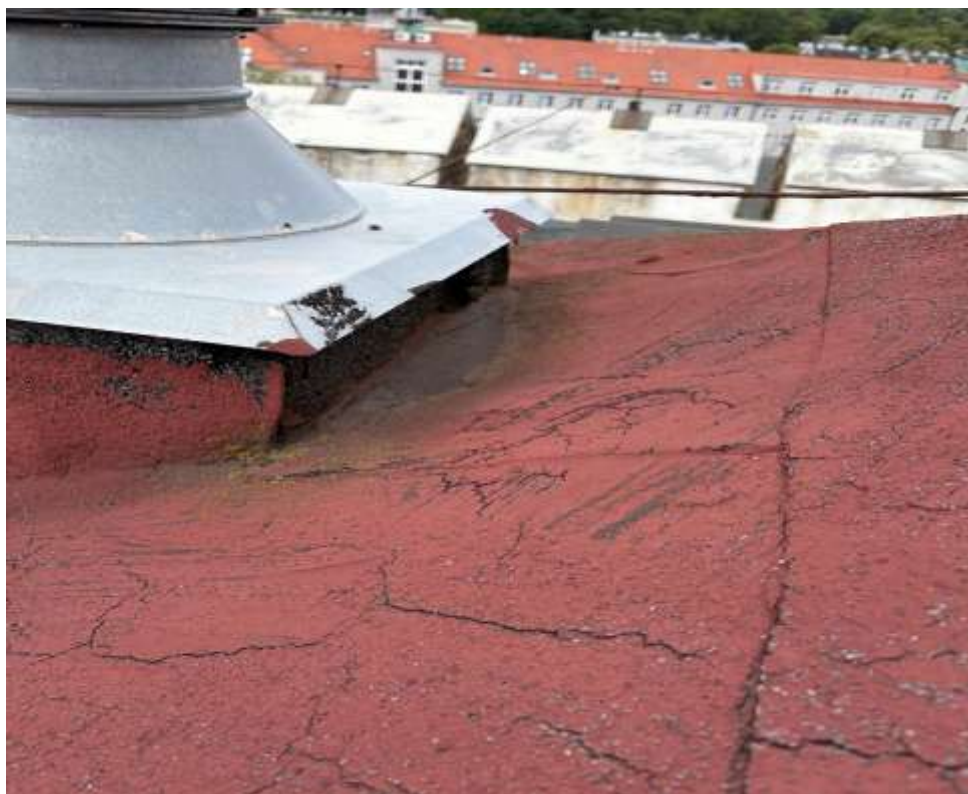
Zdjęcie 2 Widoczna niecka w której zbiera się woda'
