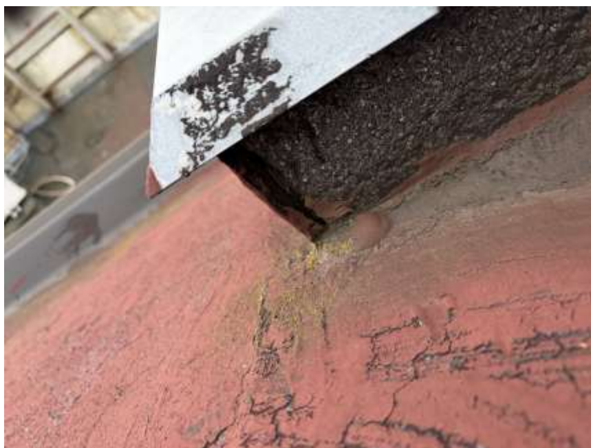
Zdjęcie 3 Widoczne pęknięcie papy
