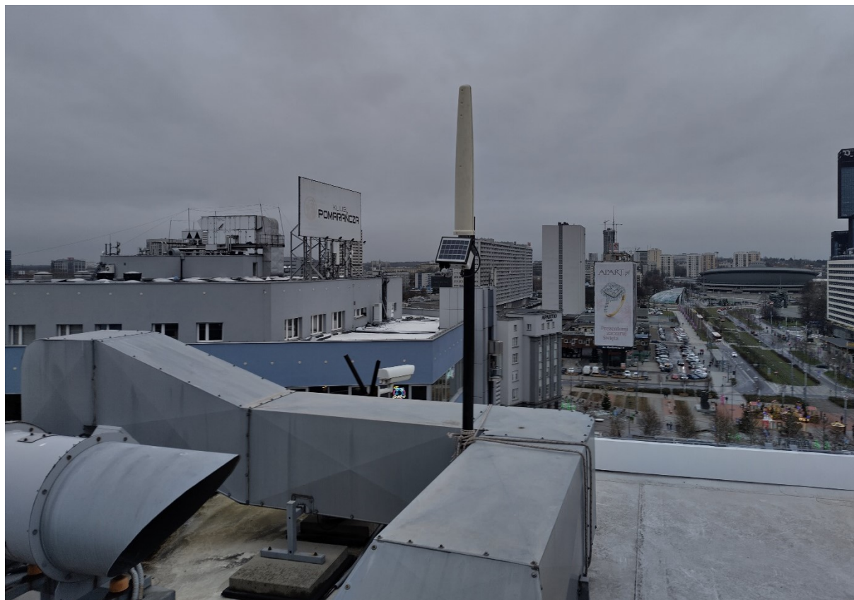
Rys. 2 Miejsce montażu SMS PEM – Rynek 1 – widok na SBTk
