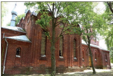
10. Dubienka, cerkiew prawosławna przed remontem, fot. Del. w Chełmie, 2017.
