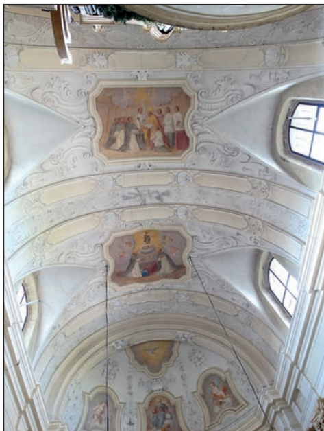
28. Sklepienie z dekoracją kaplicy Paryskiej przed pracami, fot. M. Filip, 2013.
