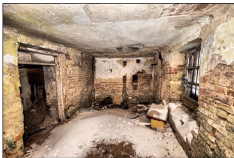
4. Dys, dwór Bernatówka, stan przed remontem, fot. od właściciela (2).
