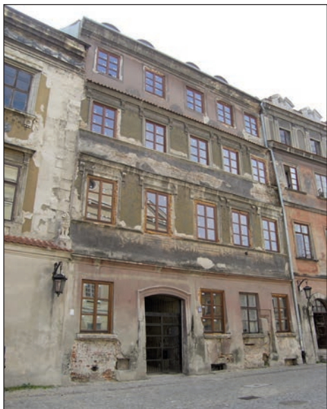
38. Lublin, Rynek 10, kamienica przed remontem, fot. B. Stolarz 2005.
