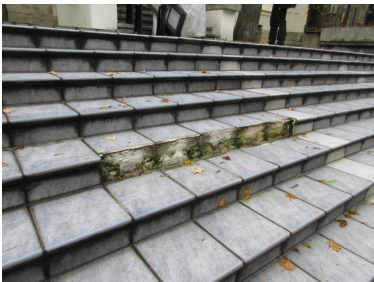
Fotografia 1. Widok uszkodzenia schodów dolnych (część wtórna).
