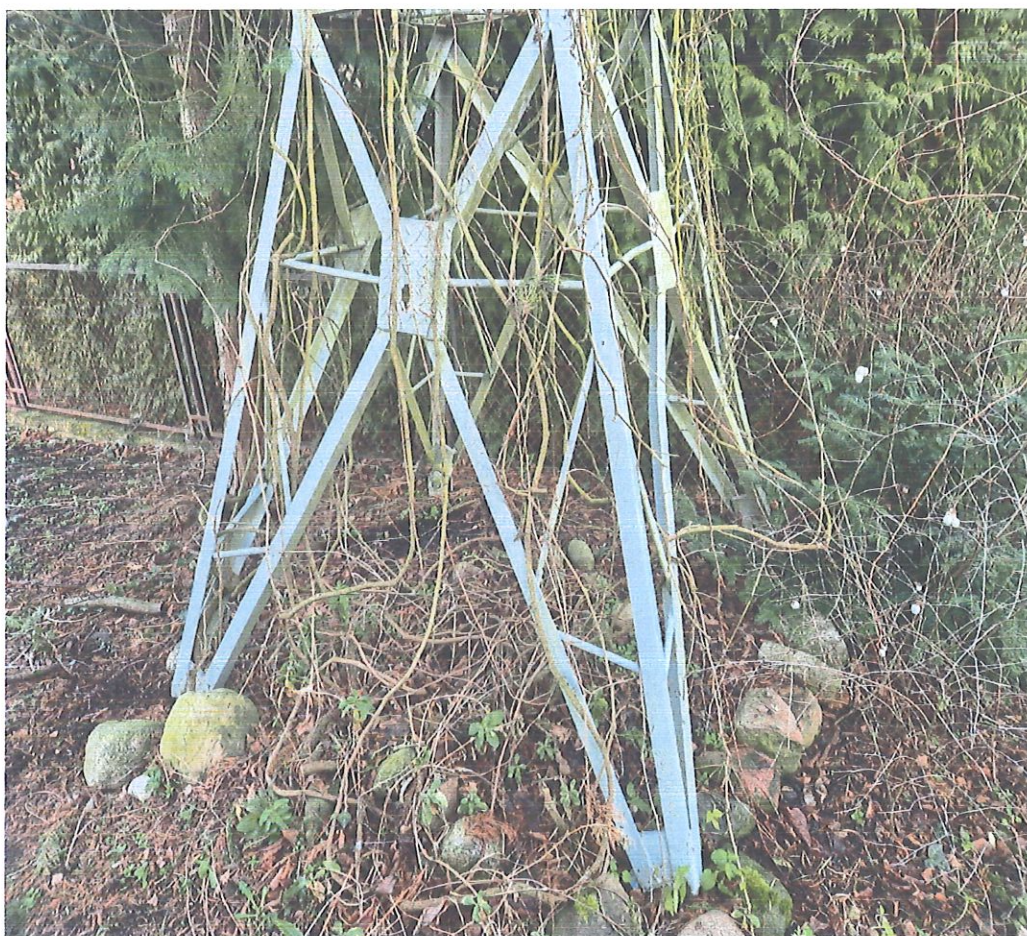
Fot nr 5 Zarośnięty fundament masztu
