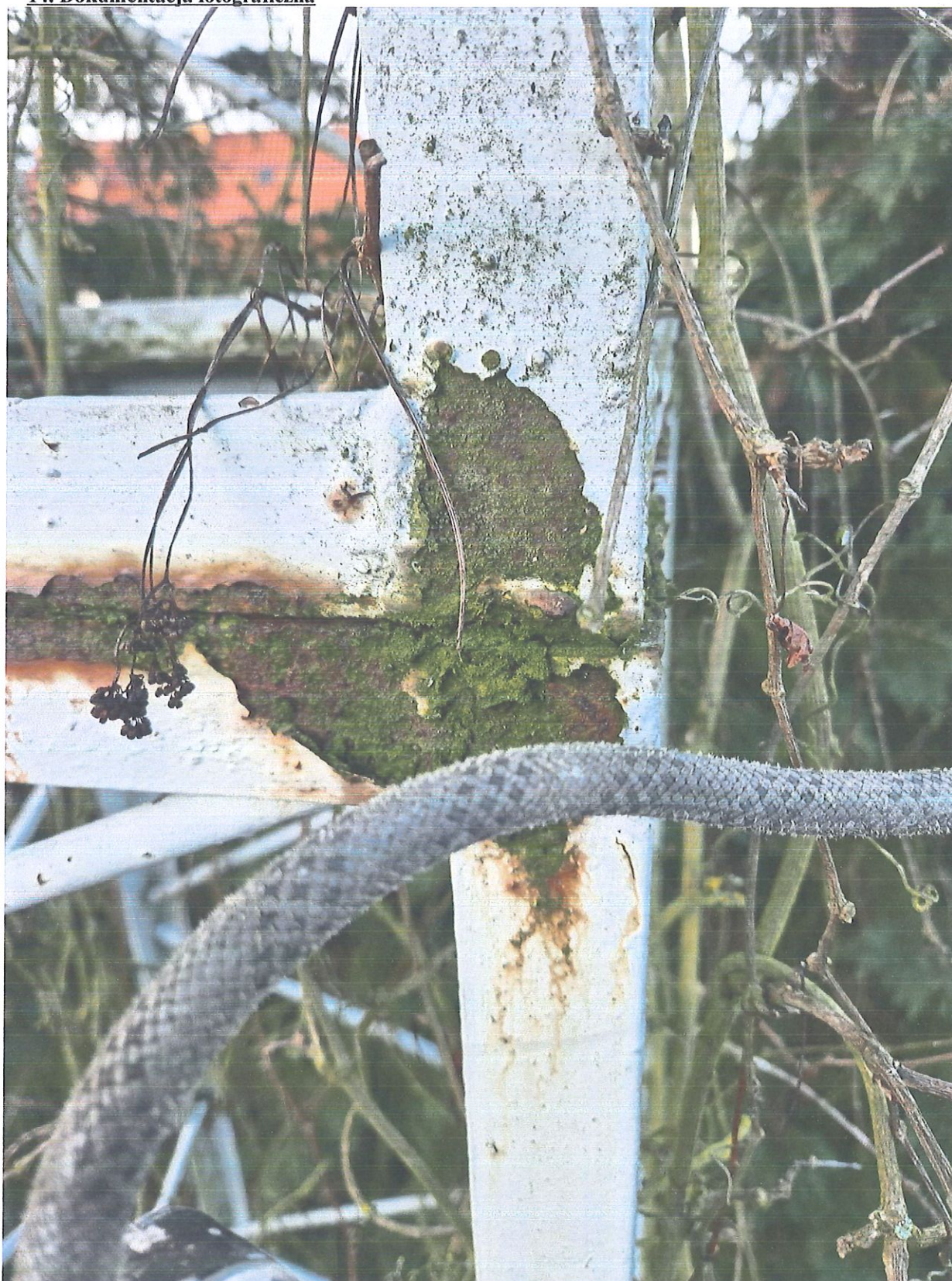
Fot. nr 1 Ubytek powłoki malarskiej i korozja na krawężnikach
