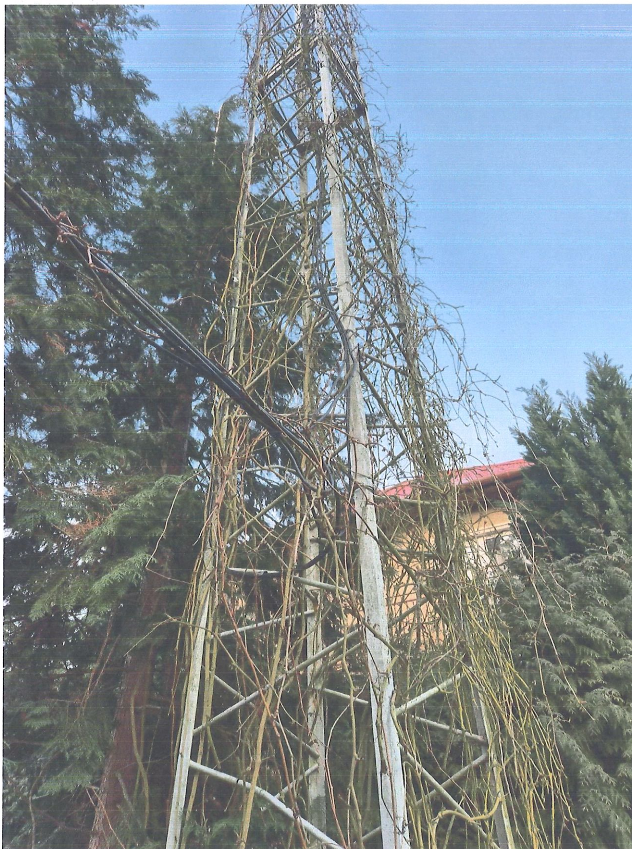
Fot. nr 2 Krzewy i pnącza na konstrukcji masztu
