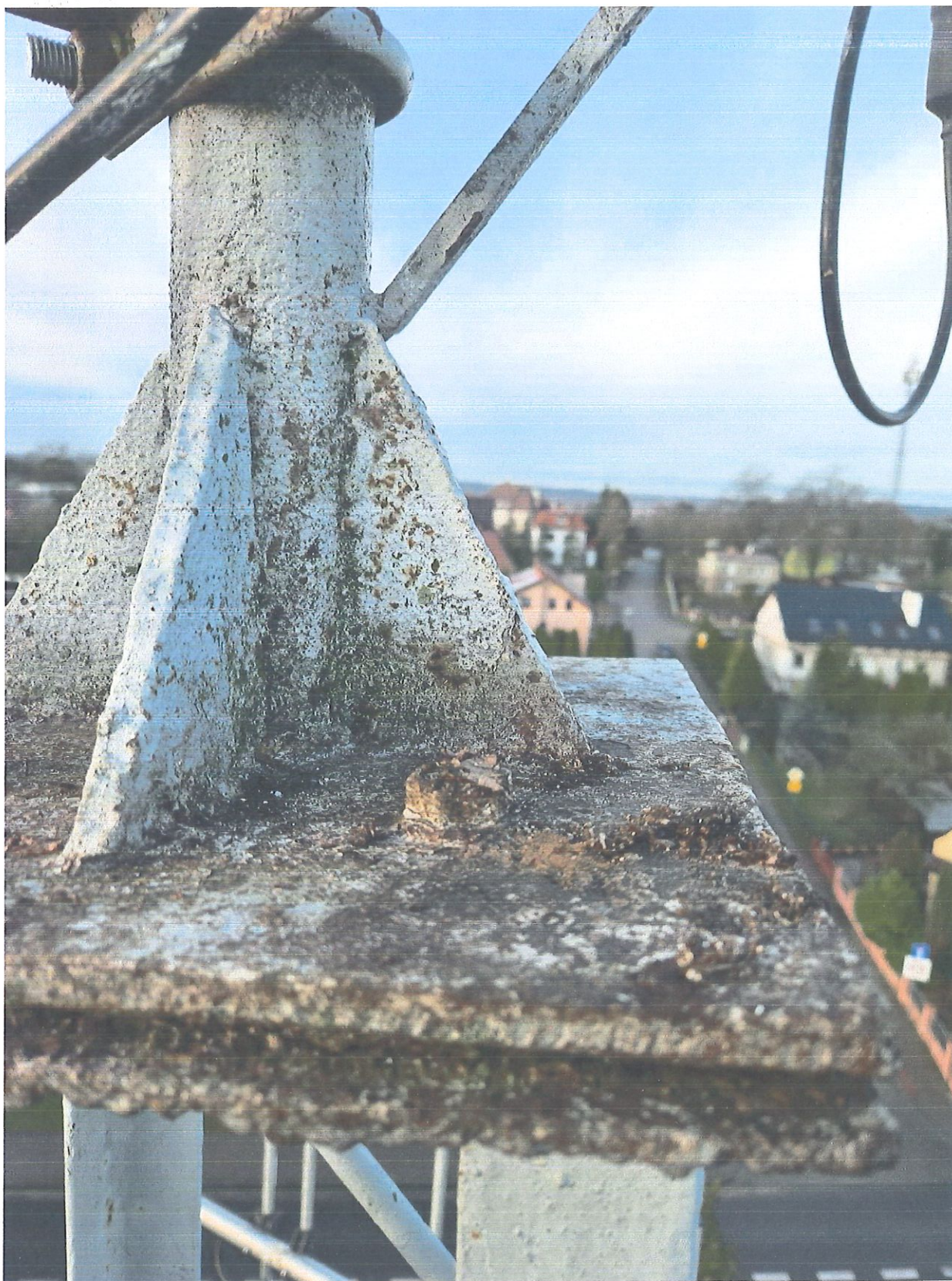
Fot nr 3 Ognisko korozji na śrubie kotwiącej rurę szczytową
