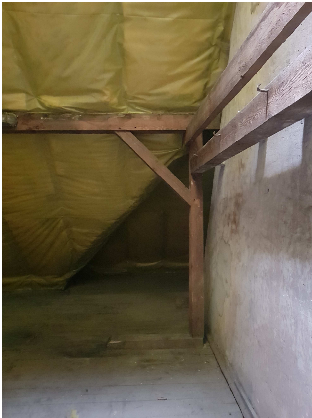
Zdjęcie numer 5 – widok na zawilgocenia elementów stropu spowodowane zaciekami, ściana komina również zawilgocona
