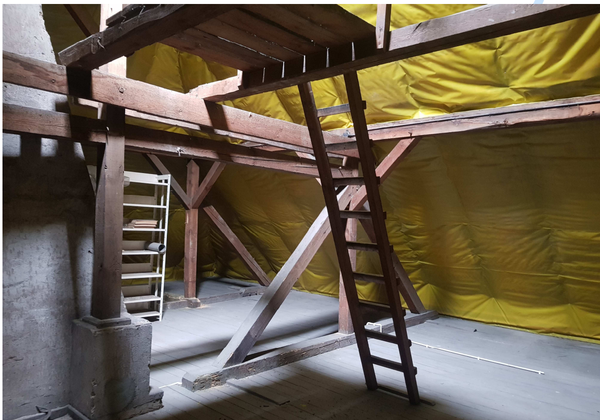
Zdjęcie numer 2 – widok komunikację prowadzącą do wylazu, korozja biologiczna belki podwalinowej
