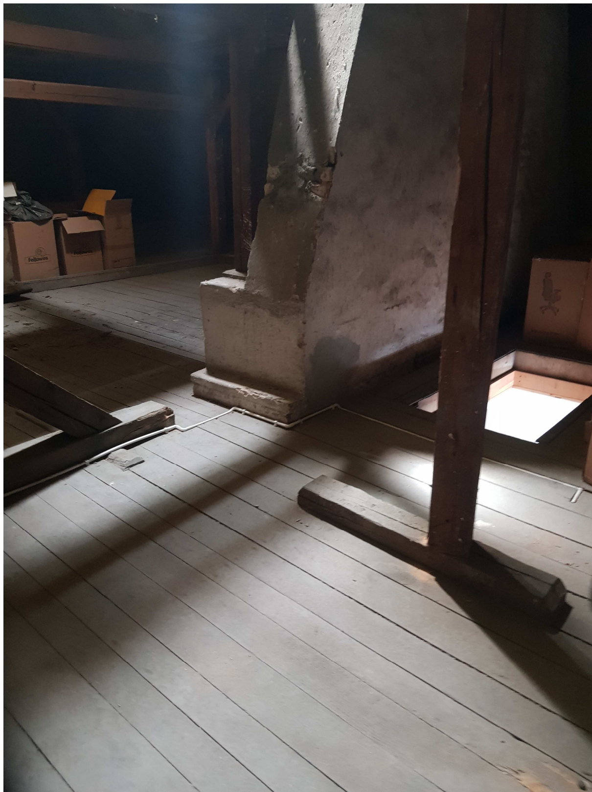
Zdjęcie numer 4 – widok na skorodowaną podwalinę oraz widoczne spękania podłużne słupa
