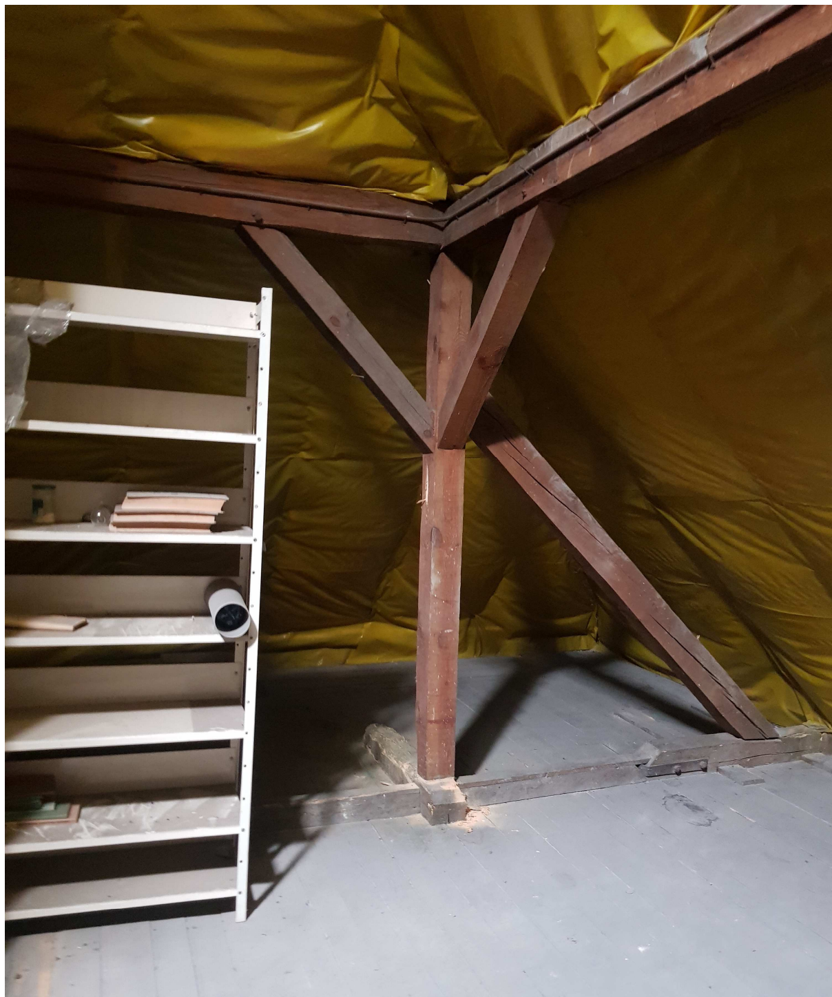
Zdjęcie numer 3 – widok na skorodowaną belkę podwalinową, widoczne spękania podłużne belki skośnej (zastrzał)
