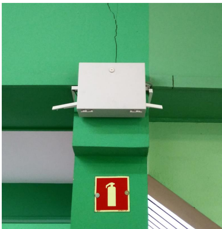
Fot. 5: Zdjęcie punktu dostępowego ukrytego w obudowie
