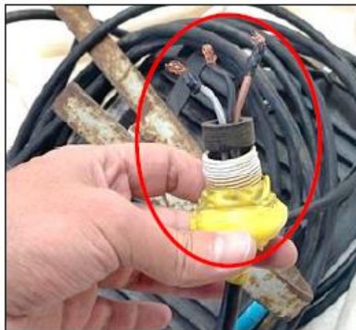
Rysunek 5: Zdemontowana wtyczka z widocznymi przewodami
