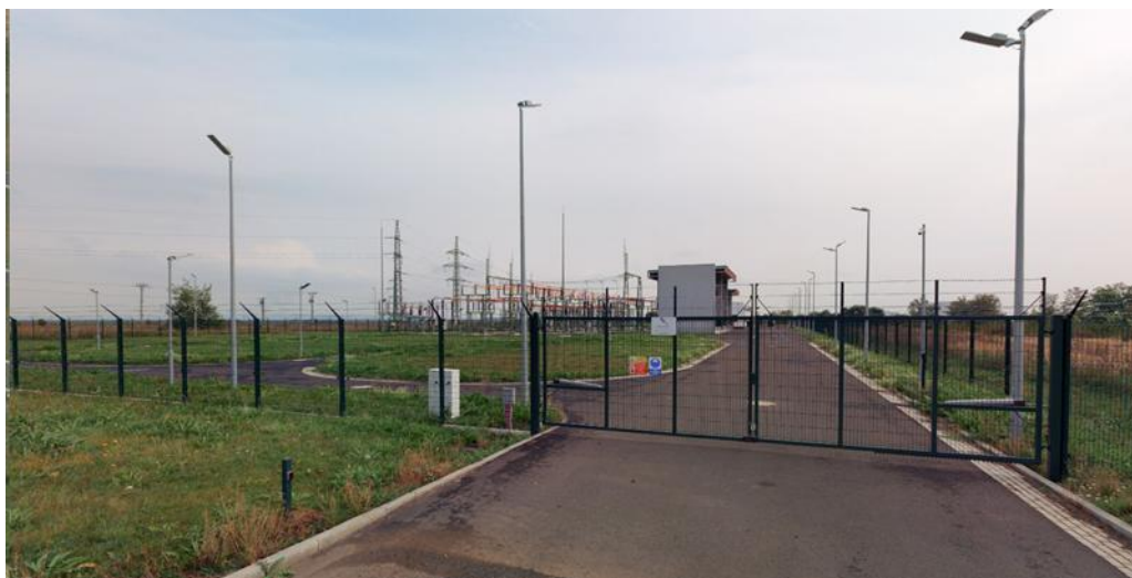
Rysunek 9: Stacja transformatorowa 110/22 kV
