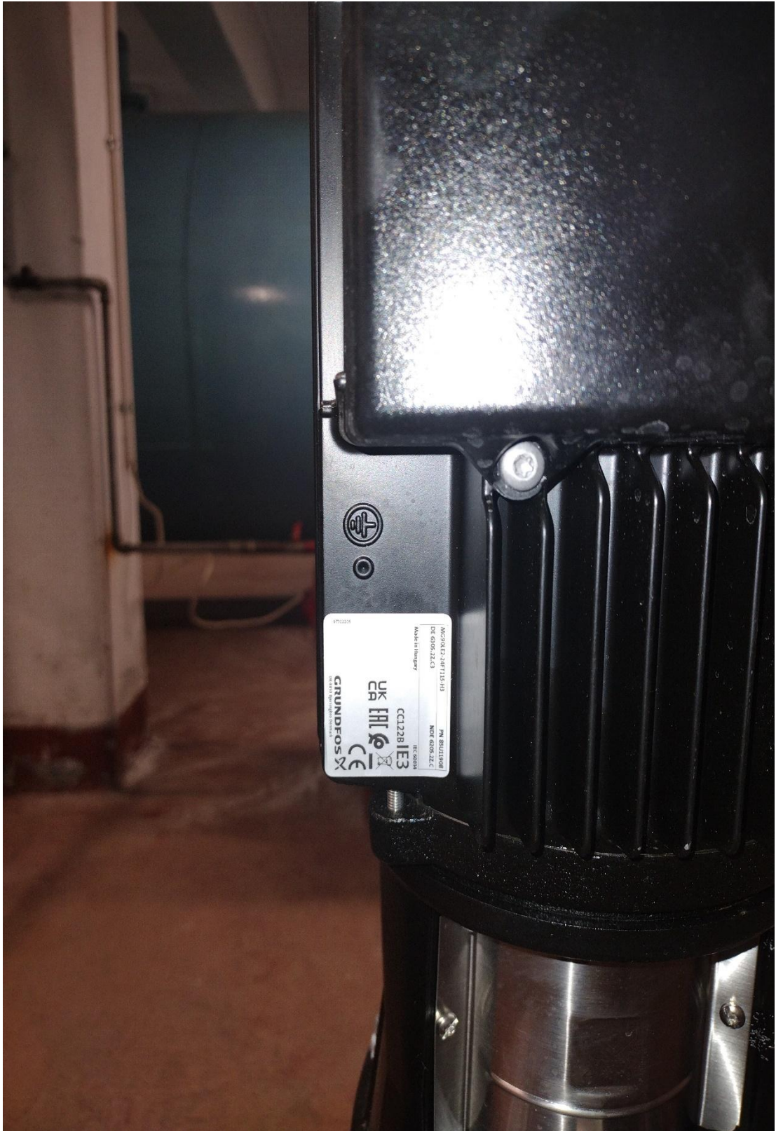
Fot. B_2 Pompa Grundfos ( zestaw hydroforowy wody bytowej)
