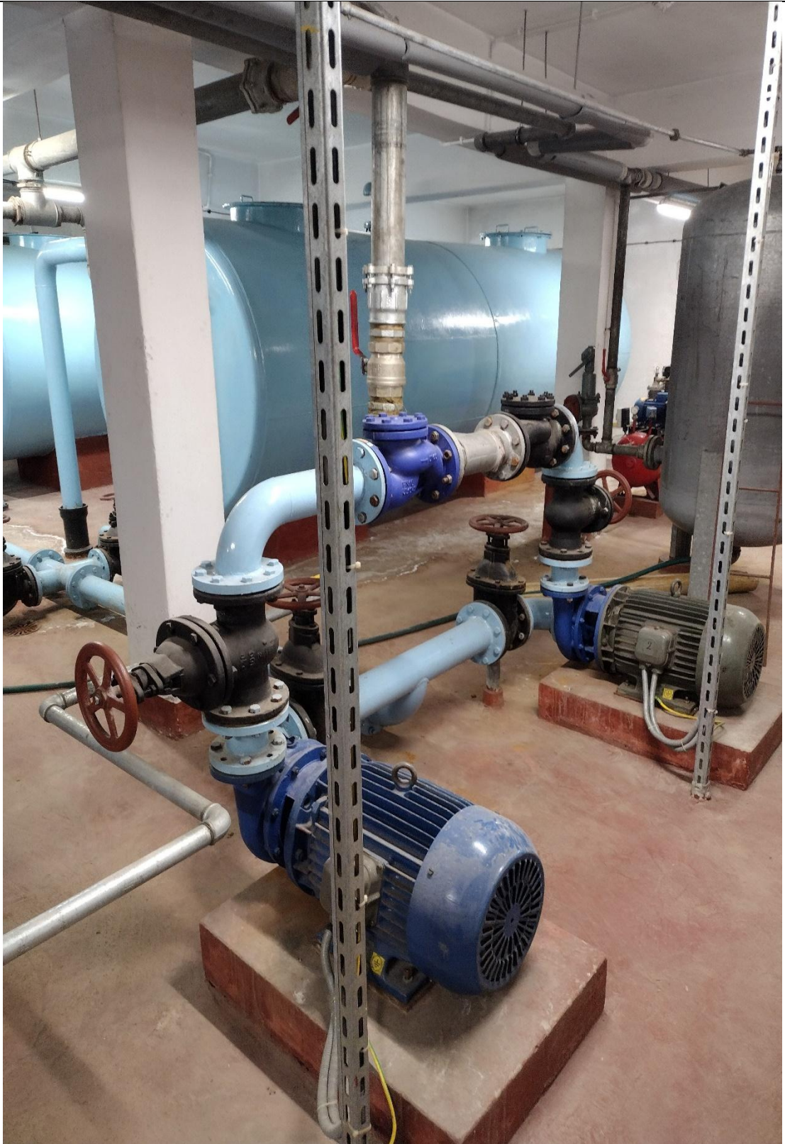
Fot. B_8 Zestaw pomp instalacji hydroforni p.poż.
