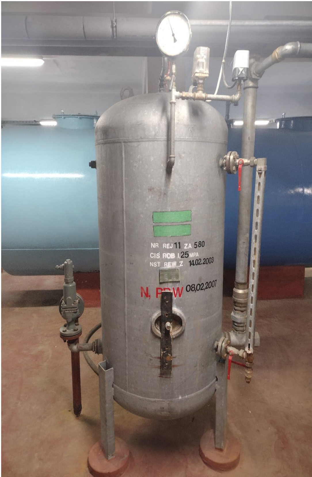
Fot. B_4. Zbiornik ciśnieniowy 800 l. (zestaw hydroforowy p.poż.)
