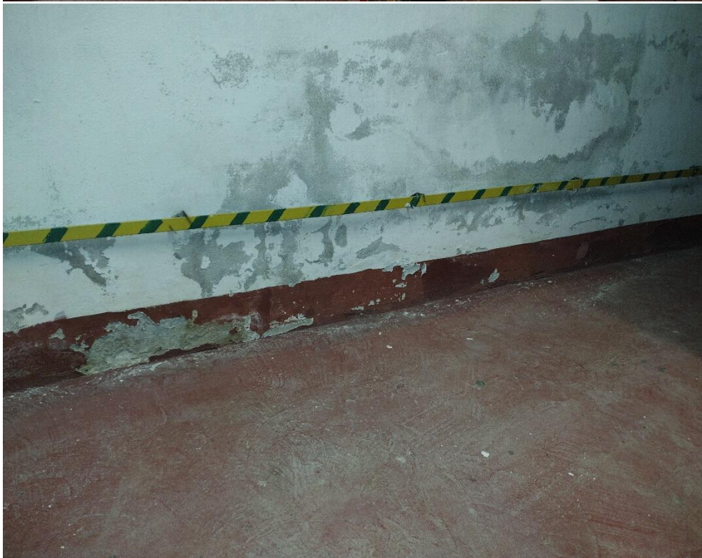
Fot. A_2 i A_3 Wykwity wilgoci na ścianie żelbetowej
