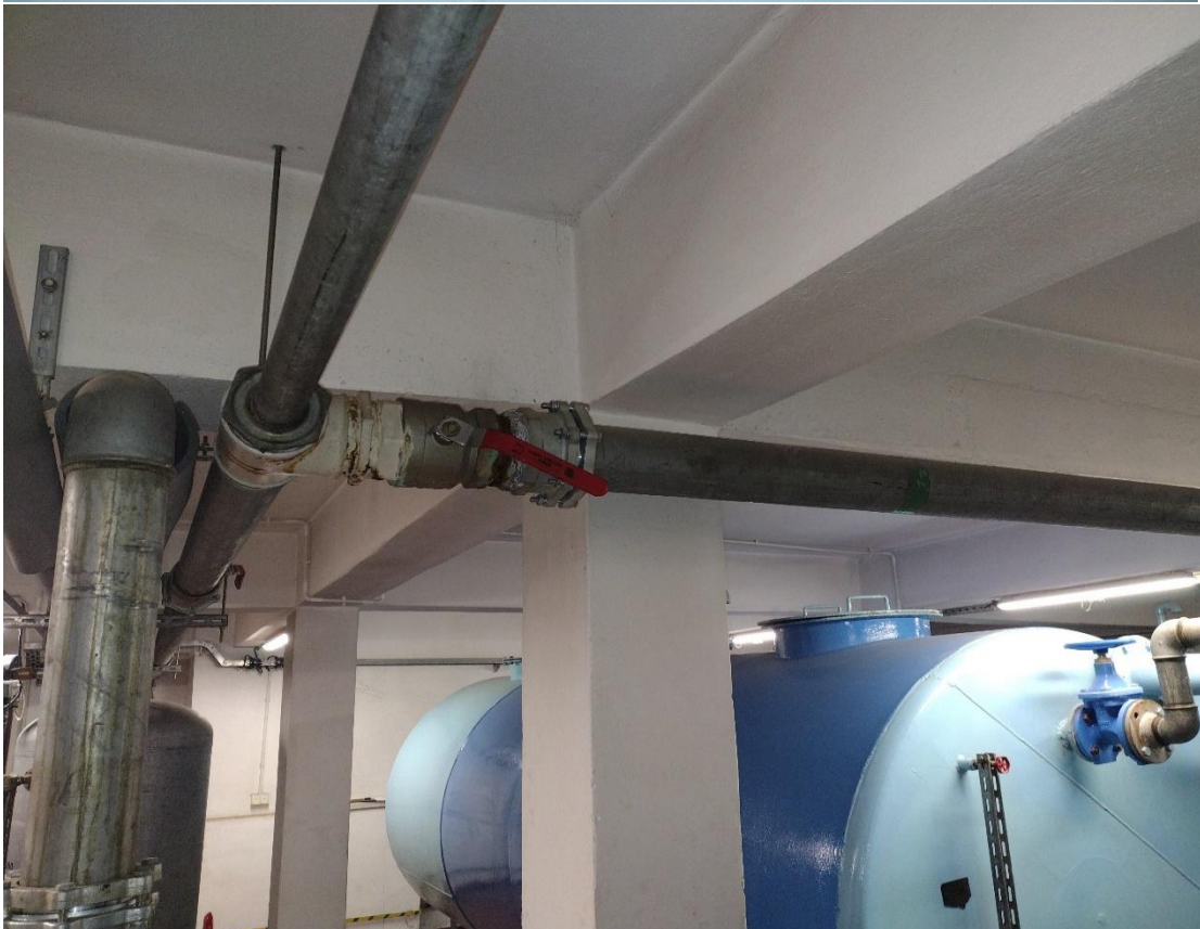
Fot. B_6 i B_7 Elementy hydroforni p.poż.
