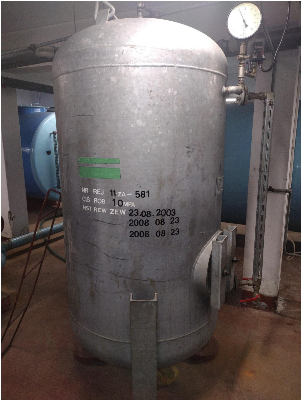
Fot. B_17 Zbiornik hydroforowy 1000l. ( instalacja hydroforowa wody bytowej)
