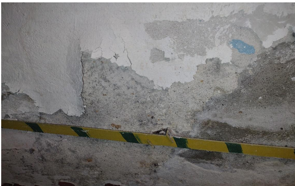
Fot. A_1 Wykwity wilgoci na ścianie żelbetowej
