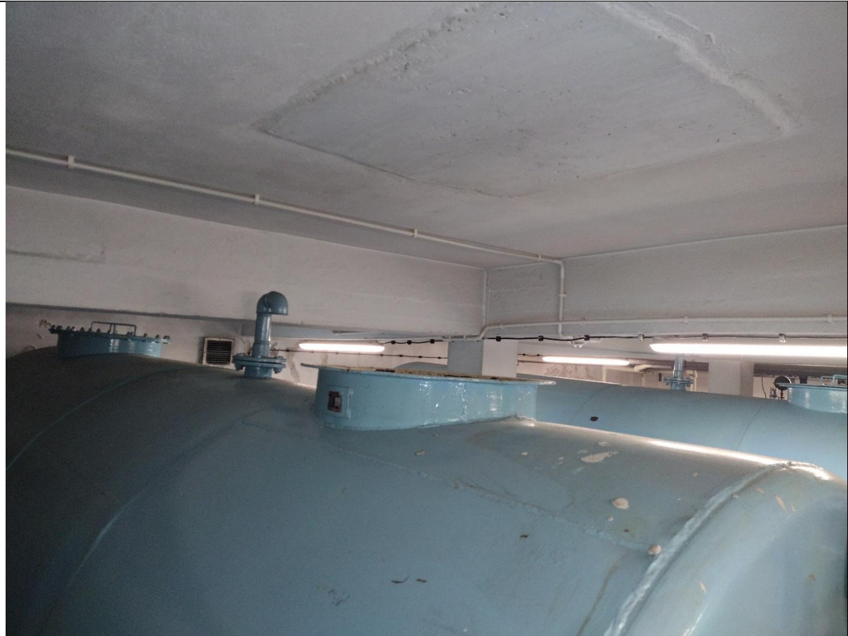
Fot. B_16 Zbiorniki wody zapasowej ( instalacja hydroforni p.poż.)
