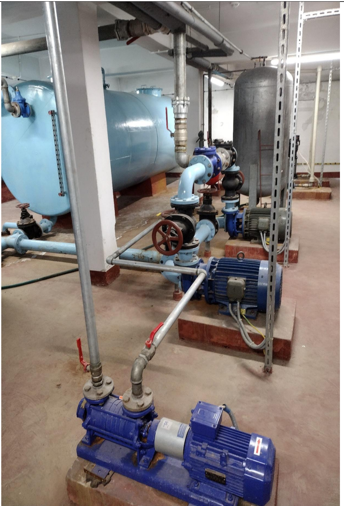
Fot. B_9 Komplet trzech pomp instalacji hydroforowej p.poż.
