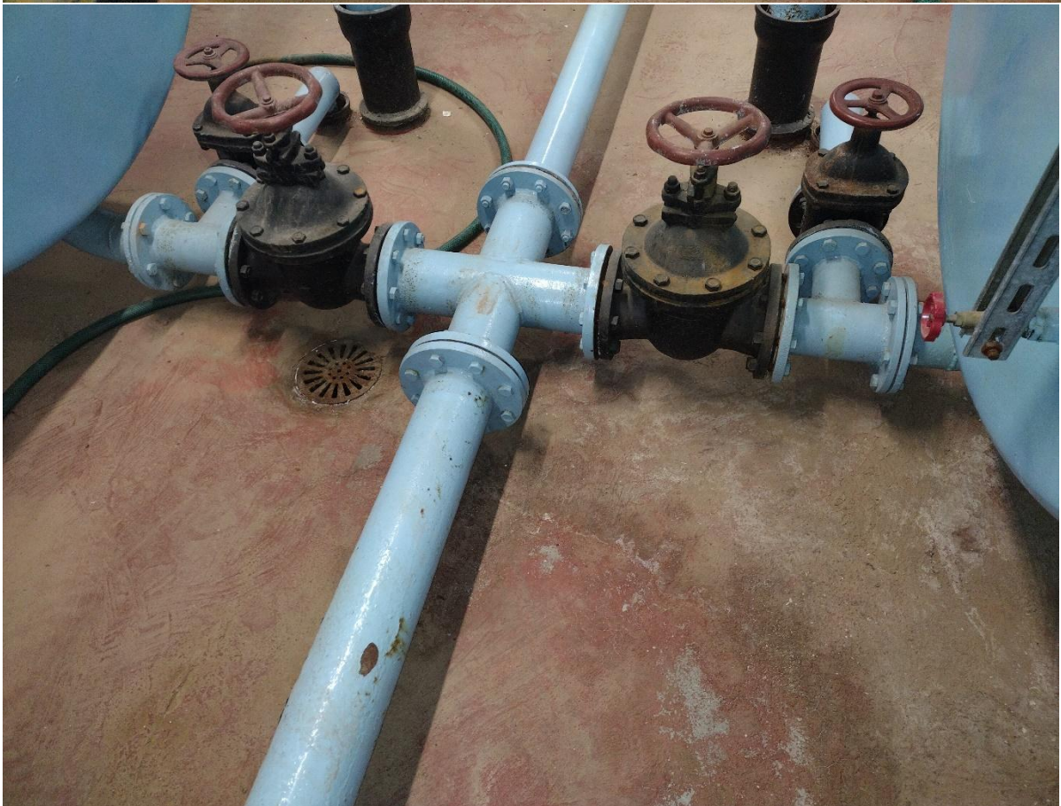
Fot. B_13 i B_14 Instalacja – rurociągi plus zawory ( hydrofornia p.poż.)
