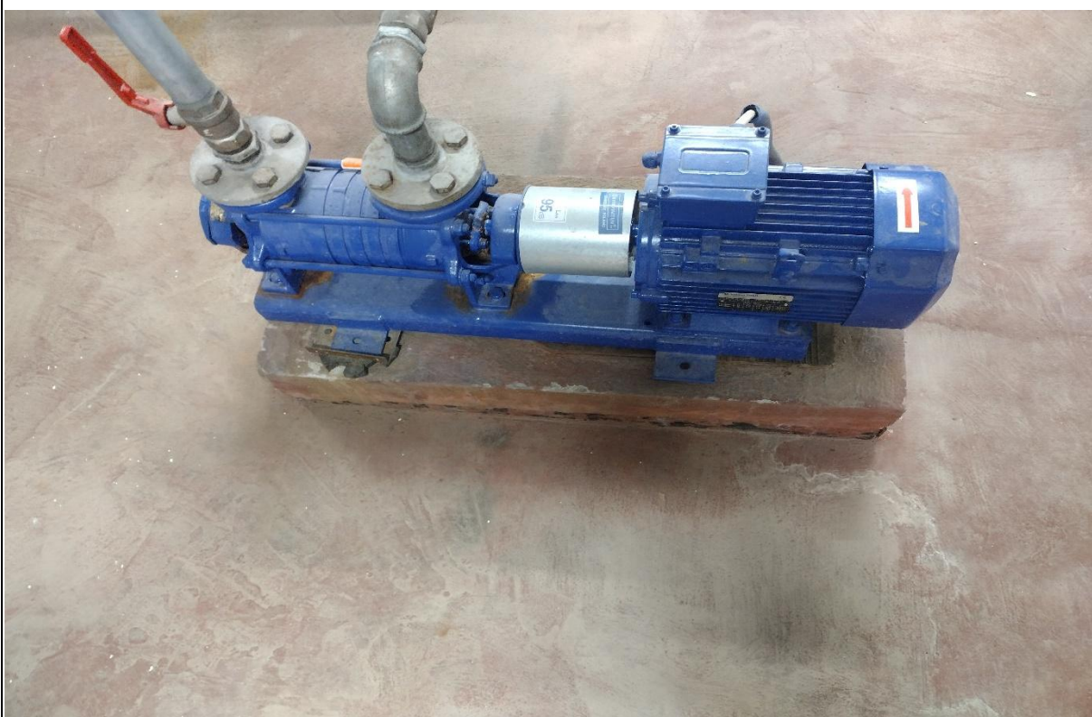
Fot. B_9 i B_10 Pompa Hydro-Vacuum SKA 3.05.1.1010 ( instalacja p.poż)
