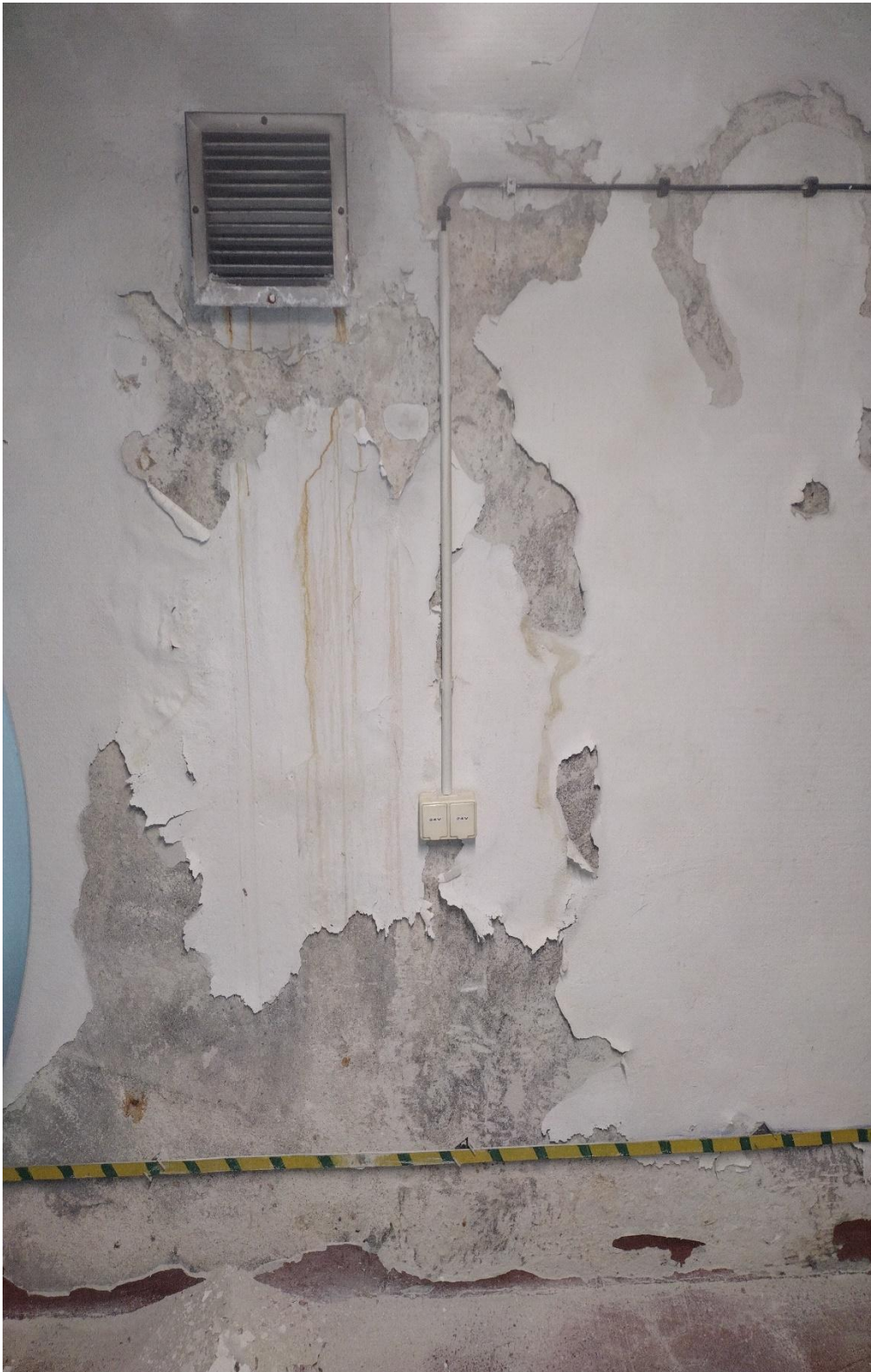
Fot. A_4 Wykwity wilgoci na ścianie żelbetowej
