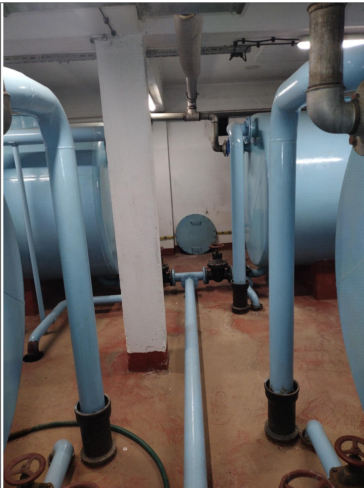
Fot. B_15 Instalacja Hydroforni p.poż.
