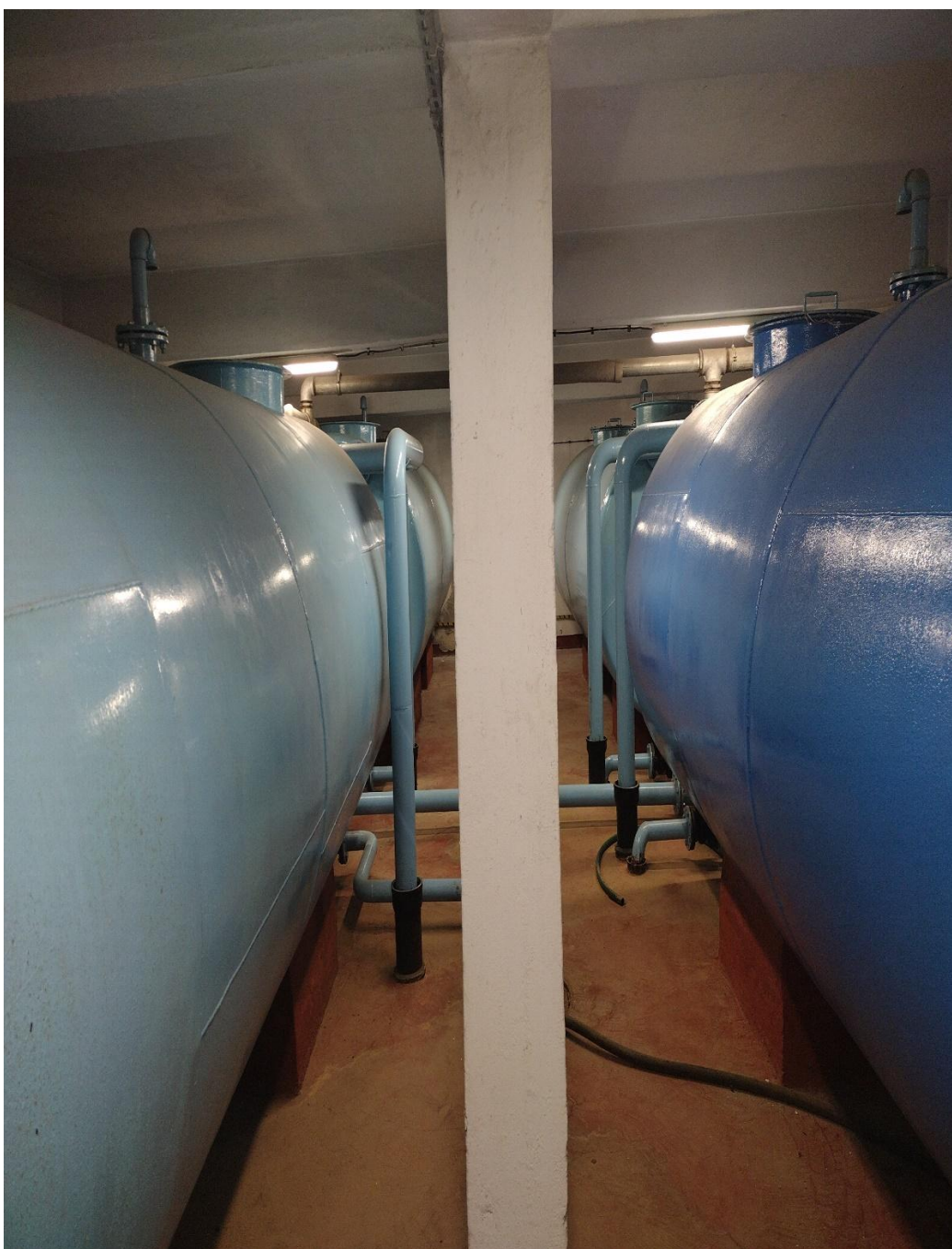
Fot. B_5. Zbiorniki bezciśnieniowe, wody zapasowej – 4 szt. Każdy o pojemności 12,5 m 3 . (Zestaw hydroforowy instalacji p.poż.)
