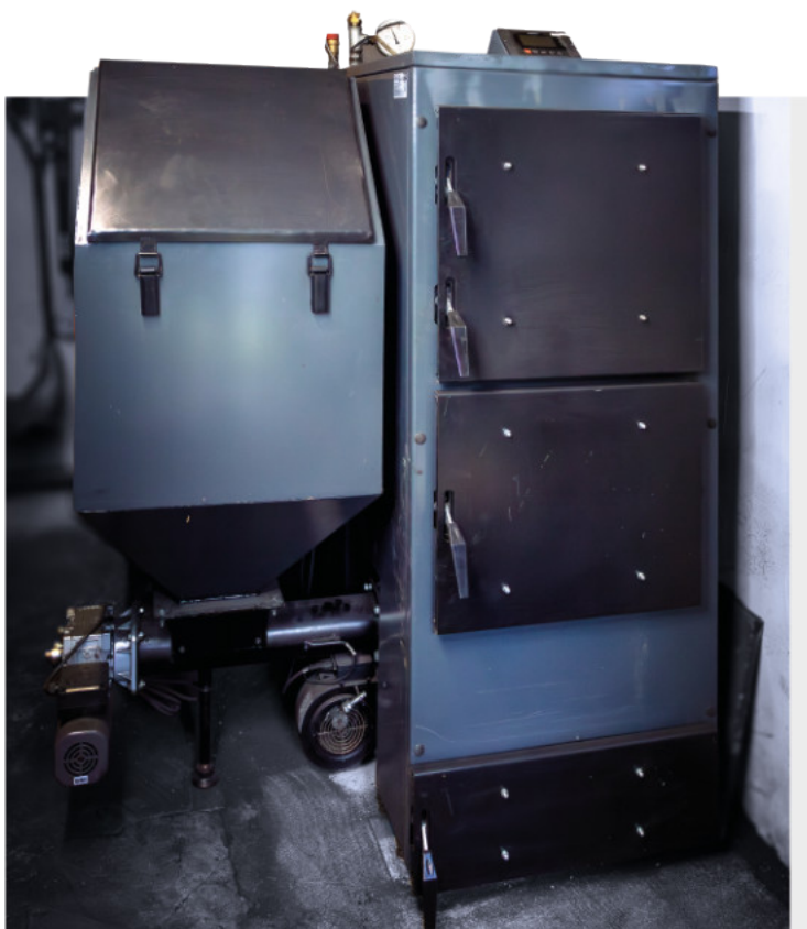
Zdj. 7. Kocioł c.o. z automatycznym zasypem paliwa, zasilany węglem kamiennym sortyment groszek, spełniający kryteria 5 klasy i ekoprojektu, w miejscu stałego użytkowania
