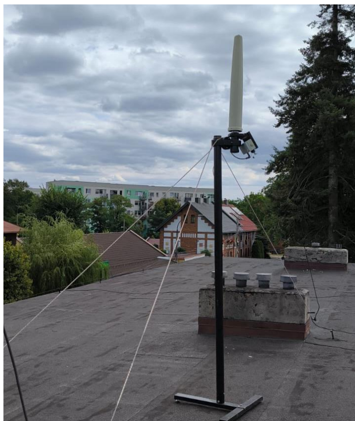
Rys. 2. Miejsce montażu SMS PEM – Budynek usługowy, Tarnowskie Góry
