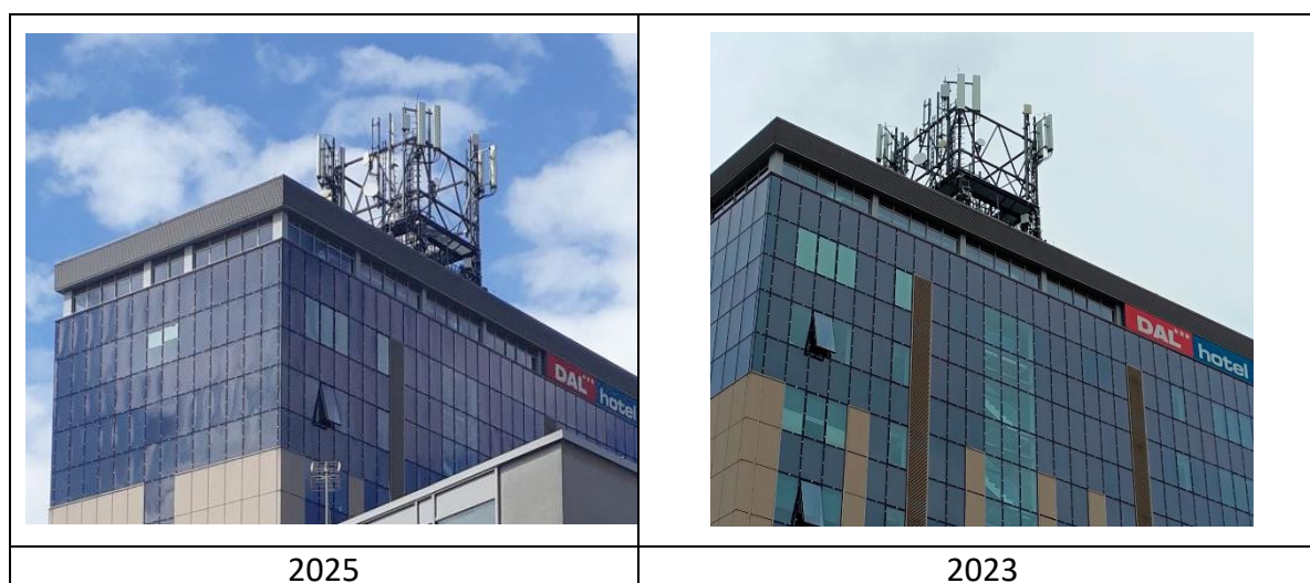
Rys. 12: Widok anten stacji bazowej – ID: 55105
