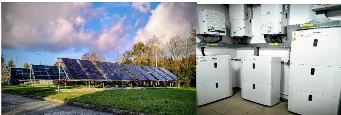
Rysunek 18. Panele fotowoltaiczne oraz magazyn energii.
