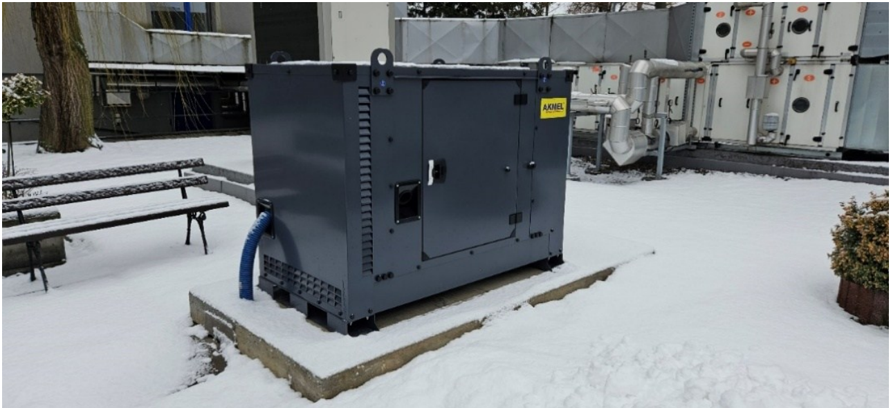
Zdjęcie 2 - WSSE w Rzeszowie – agregat prądotwórczy
