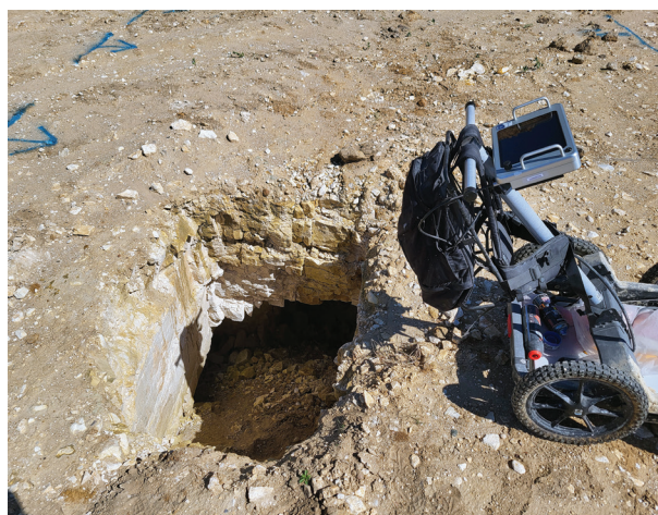
► Rys. 2. Pustka skalna w stropie I poziomu złoży Działoszyn-Trębaczew ► Fig. 2. Rock void in the ceiling of the first level of the Działoszyn-Trębaczew deposit
