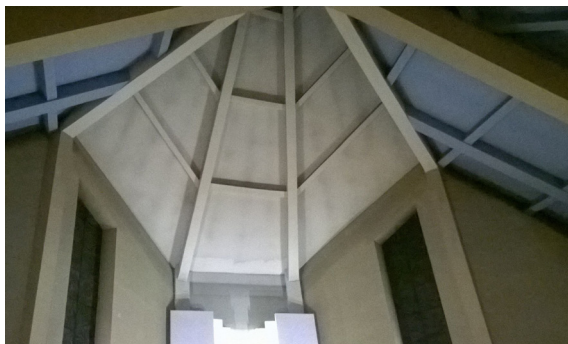
Ryc. 20. Stan w roku 2014, wzrost mikroorganizmów na sklepieniu prezbiterium jest już wyraźnie widoczny
