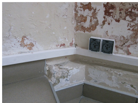
Ryc. 14. We wnętrzu założono gresową posadzkę w szczelnej, współczesnej technologii, co przyspieszyło zmieniające mikroklimat kościoła odparowywanie wody do wnętrza przez mury, także procesy niszczenia ścian i ukrytych pod pobiałami dekoracji malarskich. Wart docenienia jest natomiast sposób poprowadzenia instalacji – na powierzchni, bez kucia i niszczenia ścian
