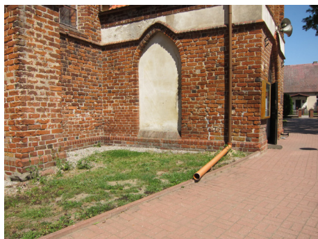
Ryc. 13. Zawilgocenie murów potęguje nierównowagę klimatyczną. W tym kościele w latach 80. przeprowadzono prace, które miały doprowadzić do jego osuszenia (drenaż). W latach 90. okolono kościół wysokim chodnikiem z jeszcze wyższym krawężnikiem. W rezultacie wywołano efekt wstawienia kościoła do „wanny z wodą”
