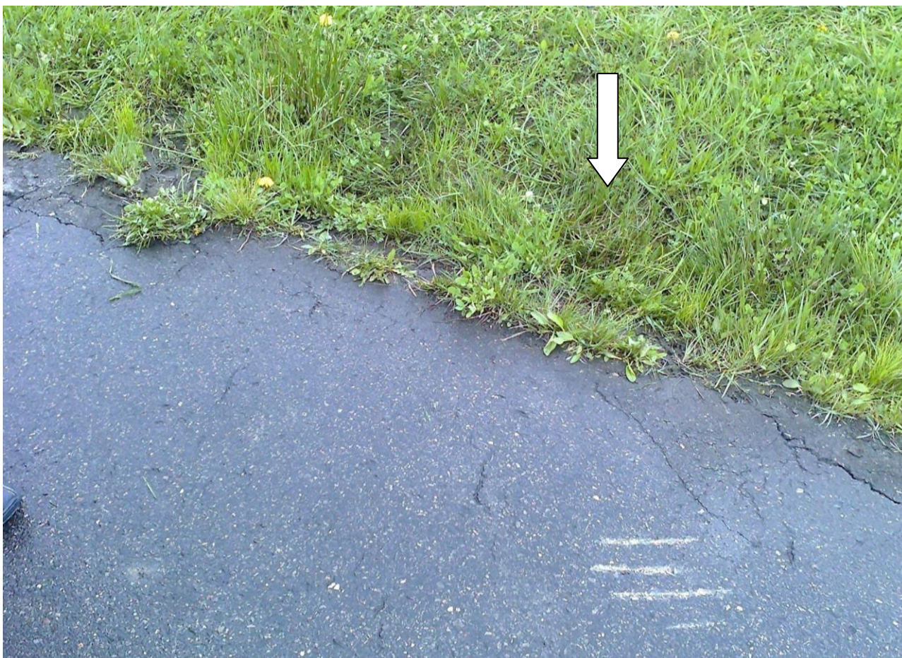
Rys.4. Zagłębienie nawierzchni trawiastej na granicy z asfaltową drogą kołowania. Poniżej widoczne ślady śmigła na asfalcie.
