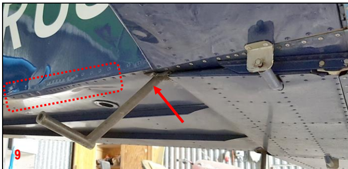
9 – Uszkodzenia kadłuba za prawym skrzydłem (lokalna deformacja dolnej podłużnicy i zgięcie prawego stopnia).
